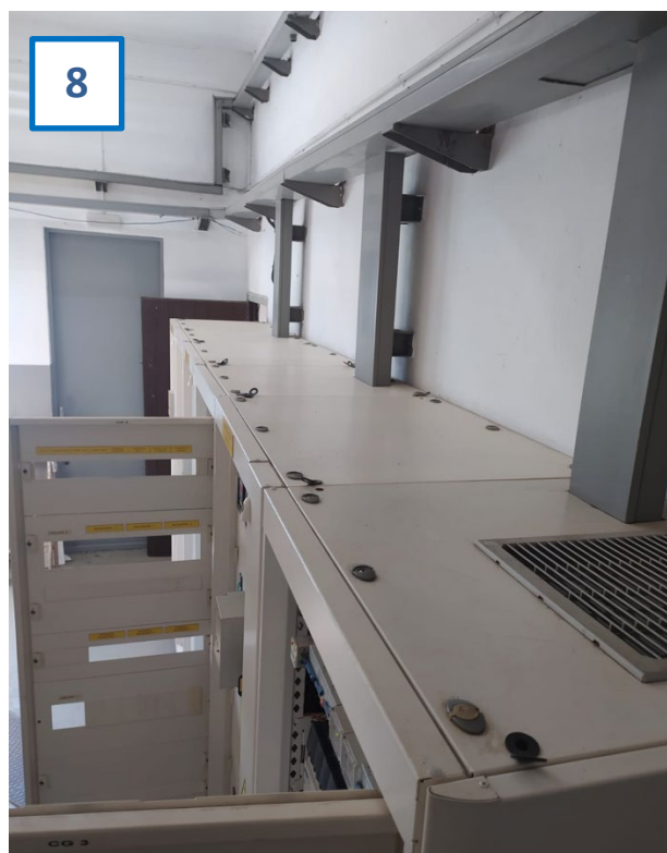
Imatge 8. Detall safates existents de la sala de Quadres generals BT Trafos
