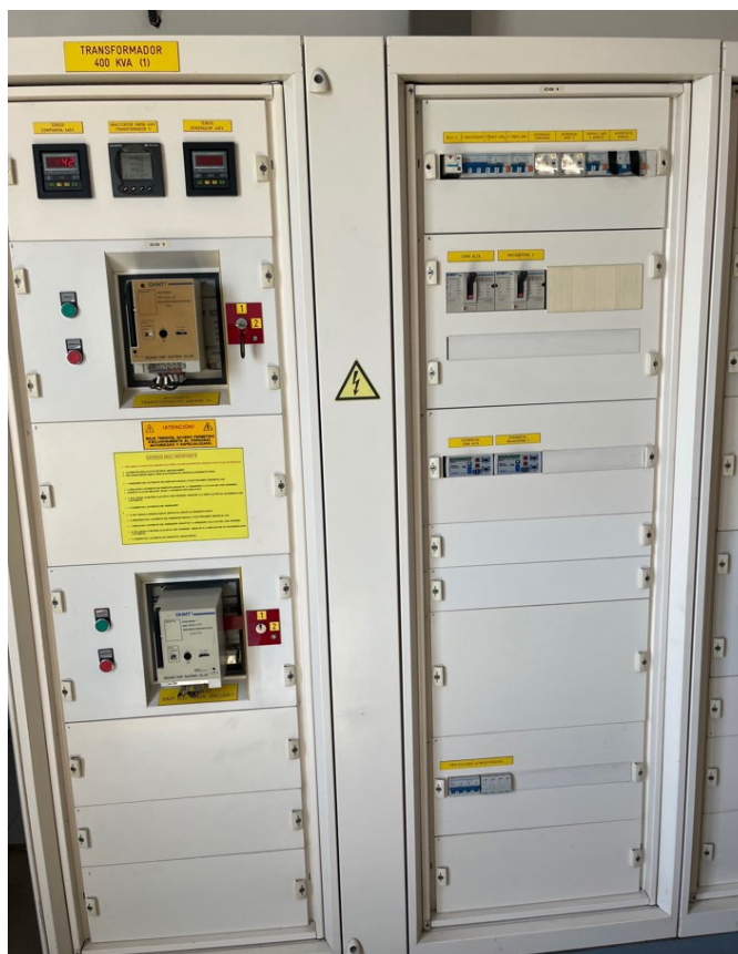
Quadre principal baixa tensió del transformador 1 on es connectarà AC de l'inversor 1
