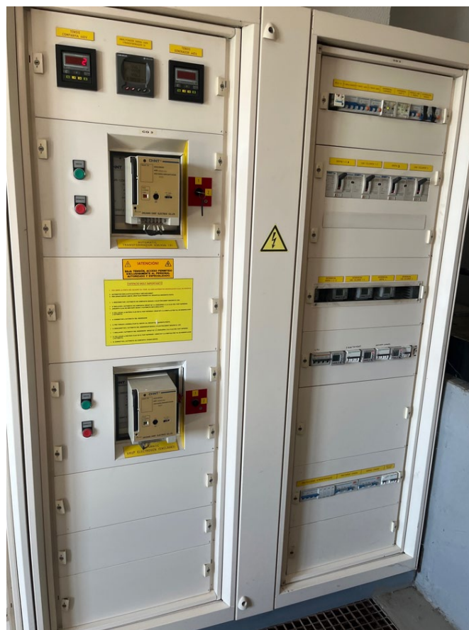
Quadre principal baixa tensió del transformador 3 on es connectarà AC de l'inversor 3
