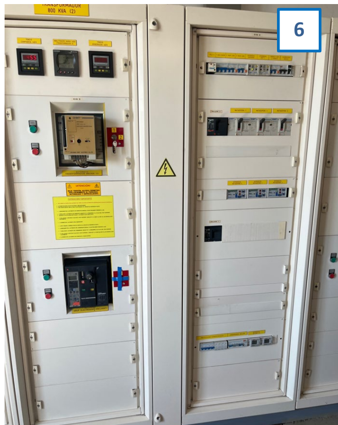
Imatge 6. Quadre general BT Trafo 2
