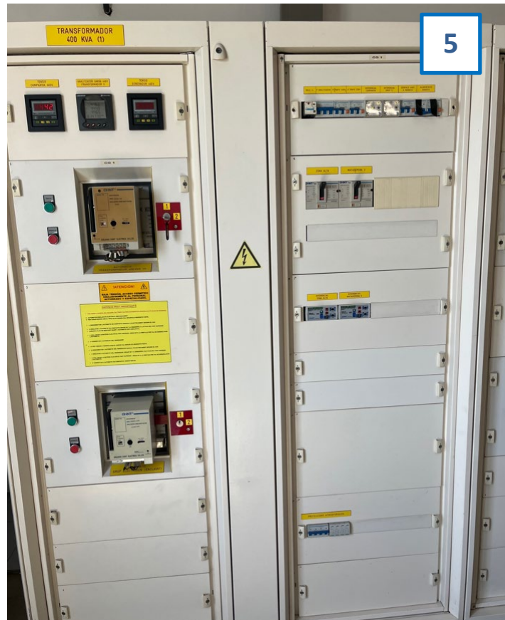
Imatge 5. Quadre general BT Trafo 1
