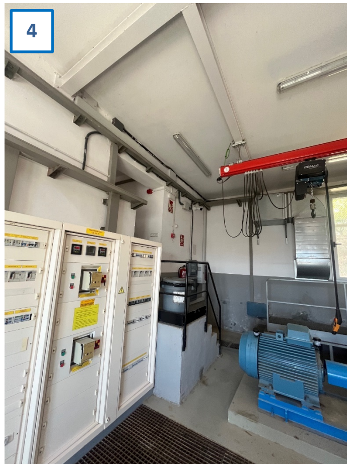
Imatge 4. Sala quadres generals transformador1-2-3 a on es connecta la instal·lació fotovoltaica
