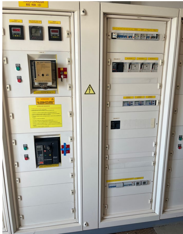
Quadre principal baixa tensió del transformador 2 on es connectarà AC de l'inversor 2
