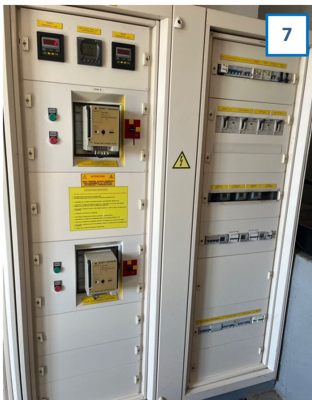
Imatge 7. Quadre general BT Trafo 3
