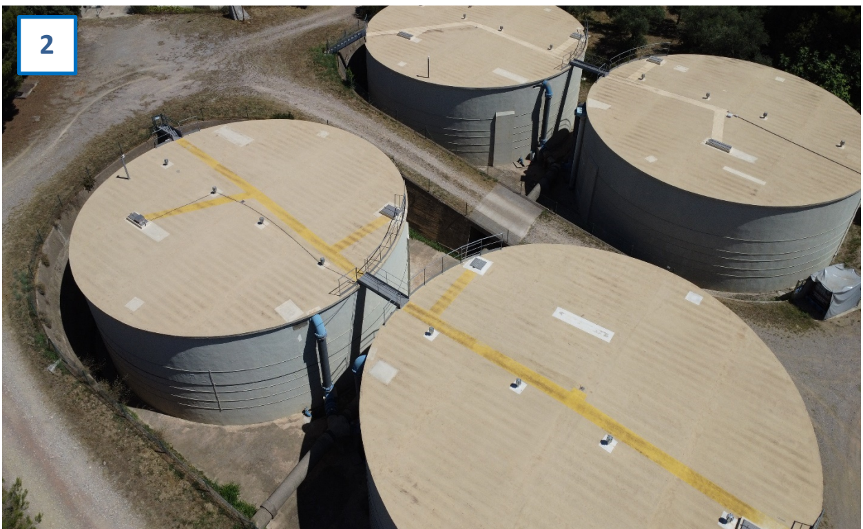
Imatge 2. Vista general de la instal·lació fotovoltaica cobertes dipòsits
