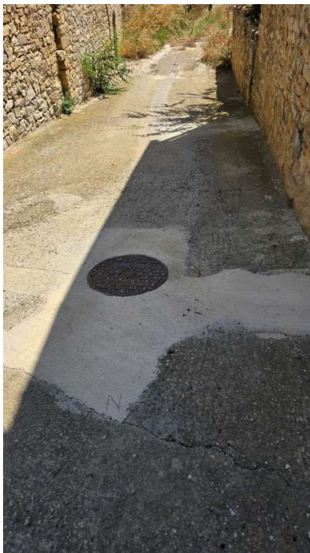
Figura 9. Arqueta C/Major, connexió a xarxa de distribució
