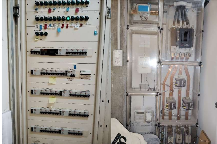
Figura 16 Ubicació de QGBT i TMF-10 de consum a la planta baixa de l'edifici
