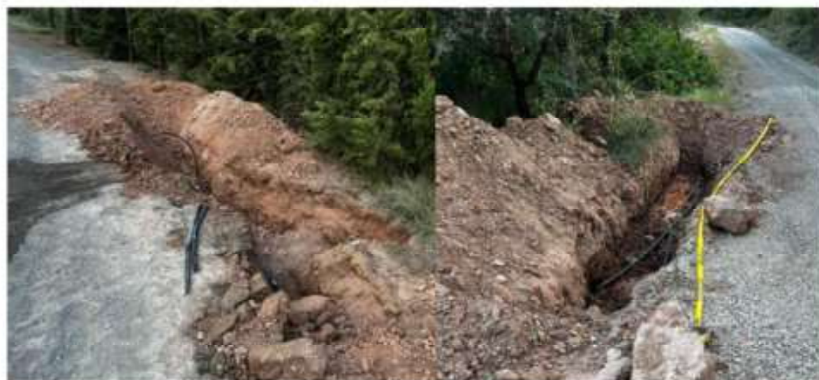
Figura 2: Treballs urgents i avaries registrades a la zona de la Urbanització
