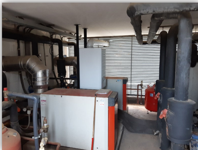
Coberta. Sala calderes / Imatge calderes
