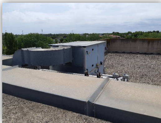
Coberta. Climatitzadors Aire primari
