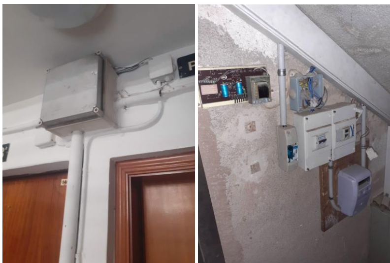
Imatge 15 Vista Instal·lacions elèctriques comunitàries
