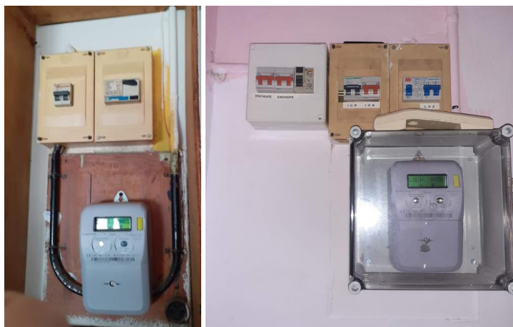
Imatge 14 Vista Instal·lacions elèctriques interiors.
