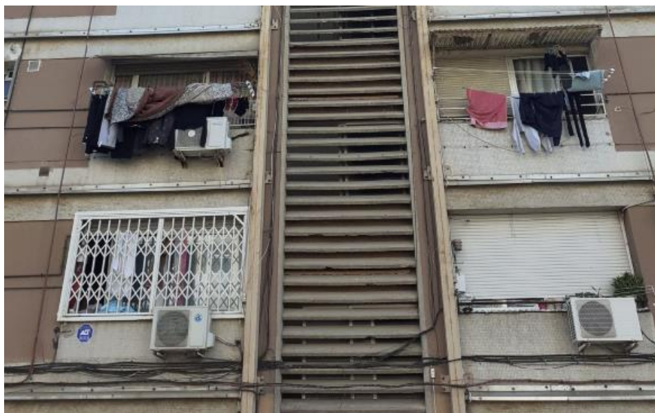
Imatge 13 Vista d'algunes unitats exterior situades a la façana.
