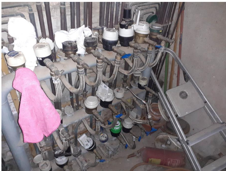
Imatge 11 Vista de la bateria de comptadors d'aigua.
