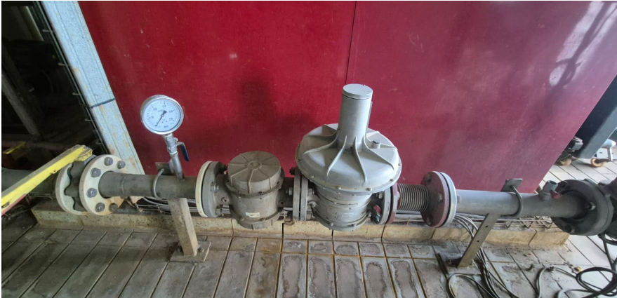
Rampa de biogàs
