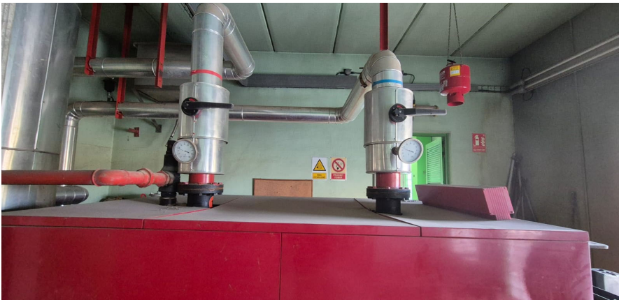
Circuit d'aigua. vàlvules d'entrada i sortida (incloses en l'abast dels treballs)
