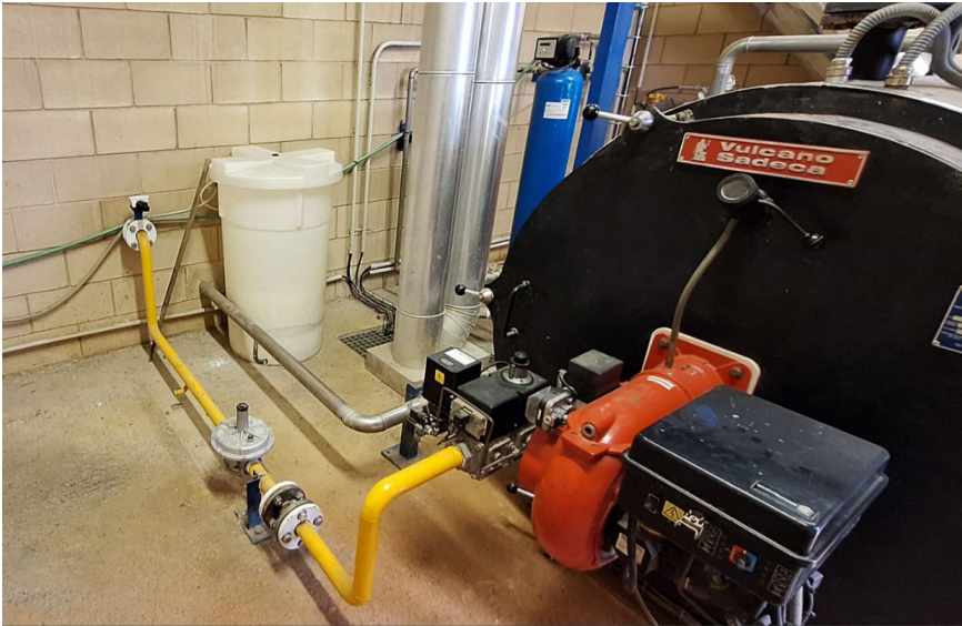
Unitat caldera-cremador a substituir i rampa de gas
