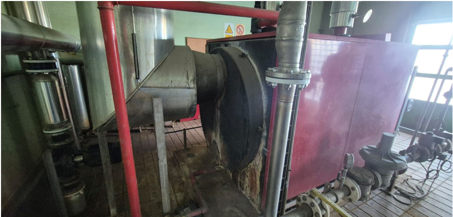
Instal·lació sortida de caldera a substituir (sortida de fums)
