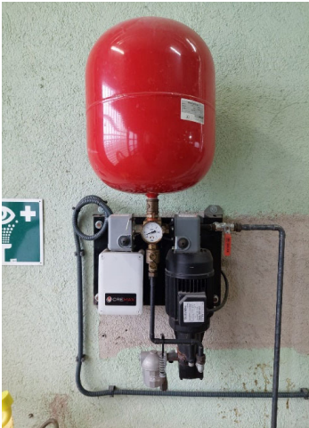
Bombes i dipòsit d'expansió gasoil (planta baixa)
