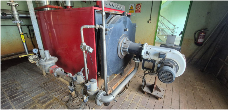
Unitat caldera-cremador a substituir
