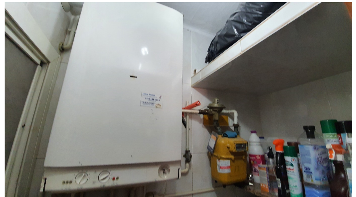
Imatge 29. Vista de les diferents instal·lacions de gas.
