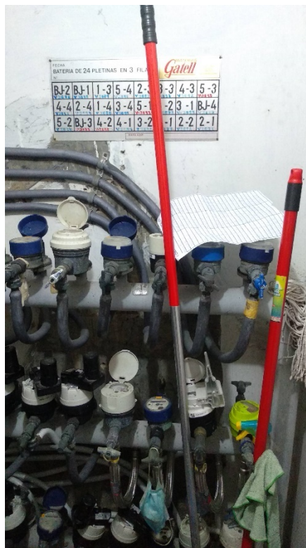
Imatge 27. Vista de la bateria de comptadors.
