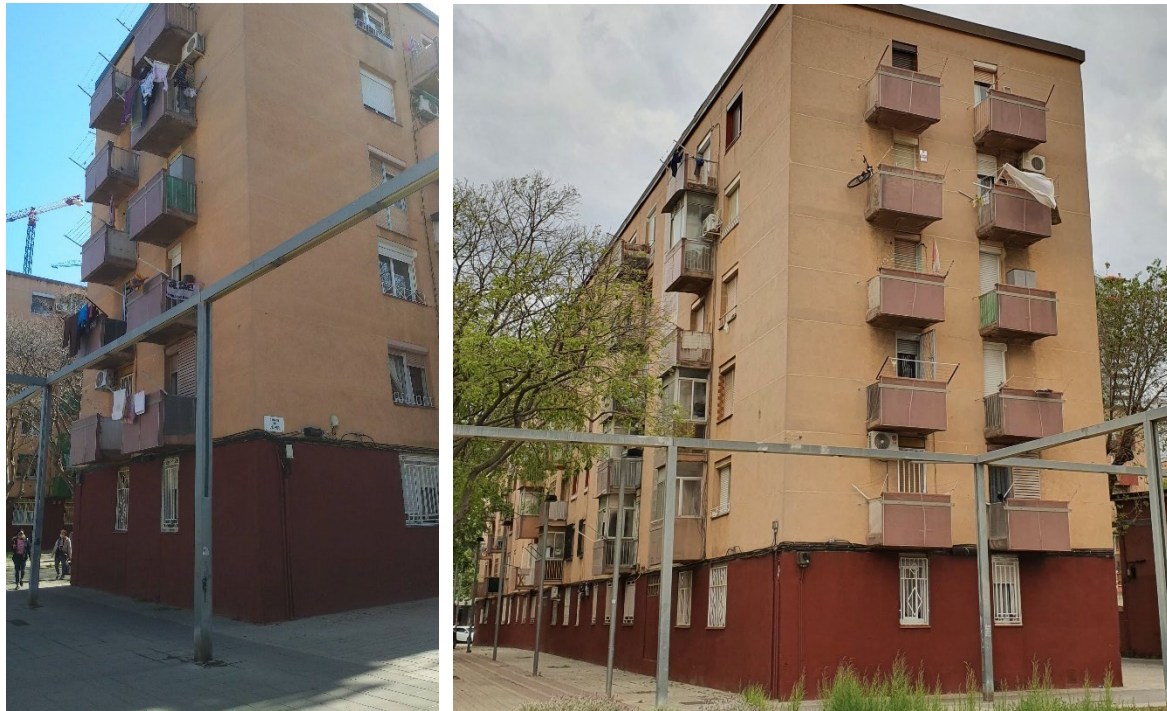
Imatge 31-32. Vistes dels diferents instal·lacions d'AC.
