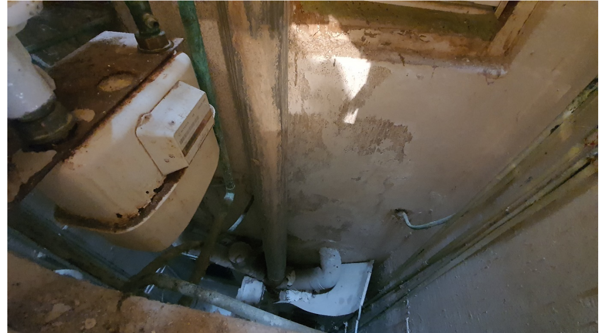
Imatge 28. Vista de les diferents instal·lacions de gas.
