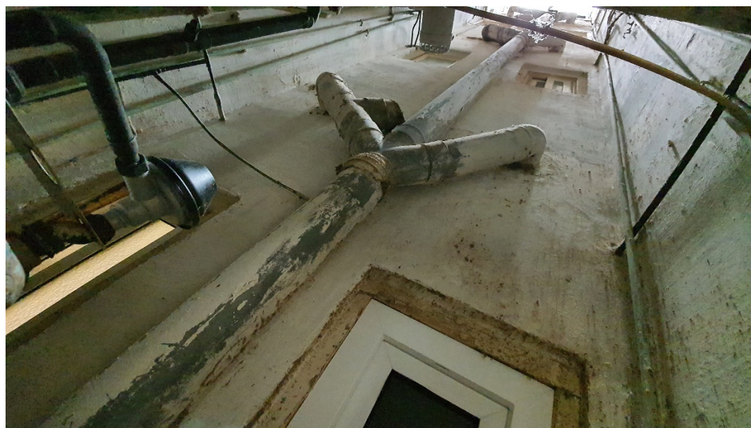
Imatge 23. Vista dels patis d'instal·lacions.
