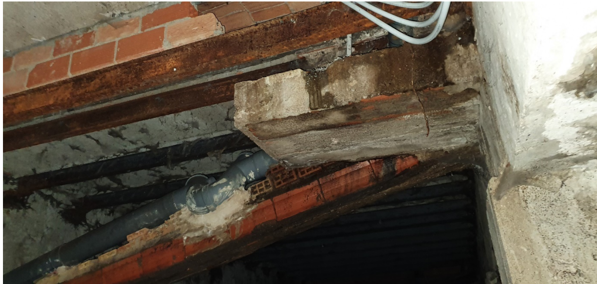
Imatge 10. Vista de reforços existents en cambra sanitària, en mal estat.
