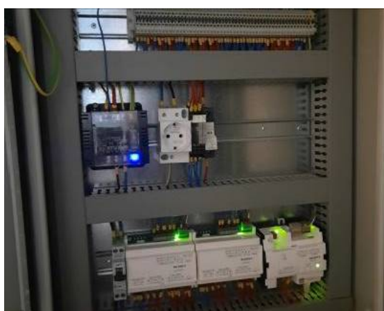
Subestació nova bacnet mòdul 5 (existent, climatitzador planta 3 zona sud)
