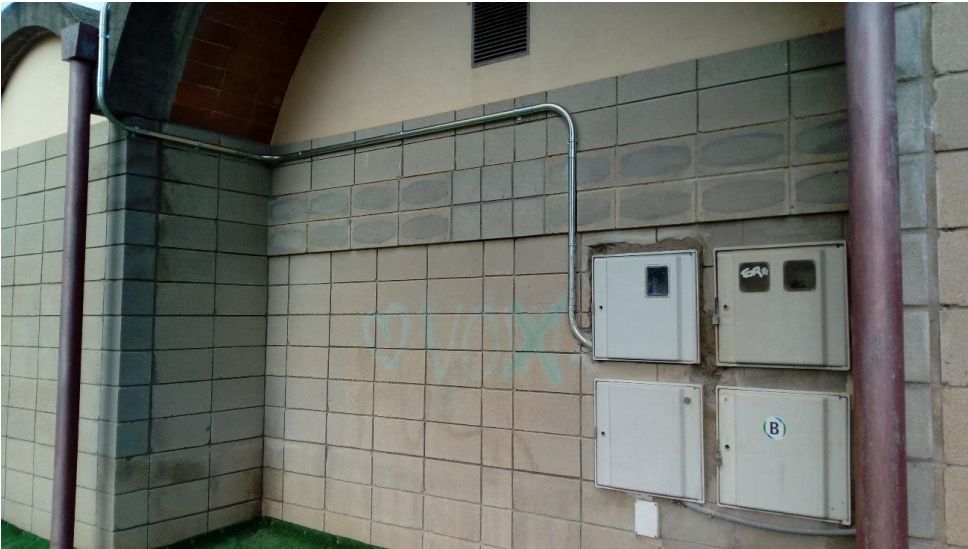
Imatge on s'hi ubicaran els armaris d'equips , el quadre de mesura amb la caixa de CGP i els armaris dels quadres de mesura.
