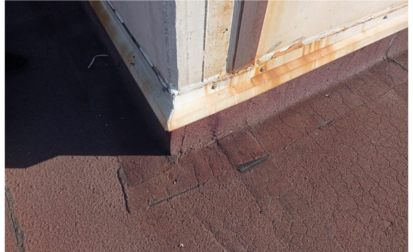
Deteriorament del segellat de les juntes del perfil de protecció de la impermeabilització.
