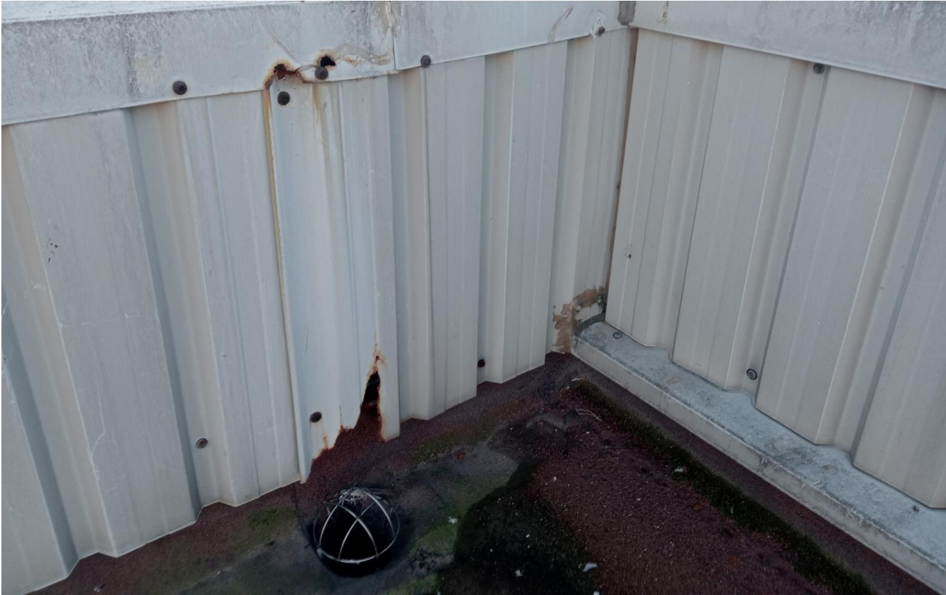
Corrossió puntual de les xapes de revestiment de l'ampit i de coronament de coberta.
