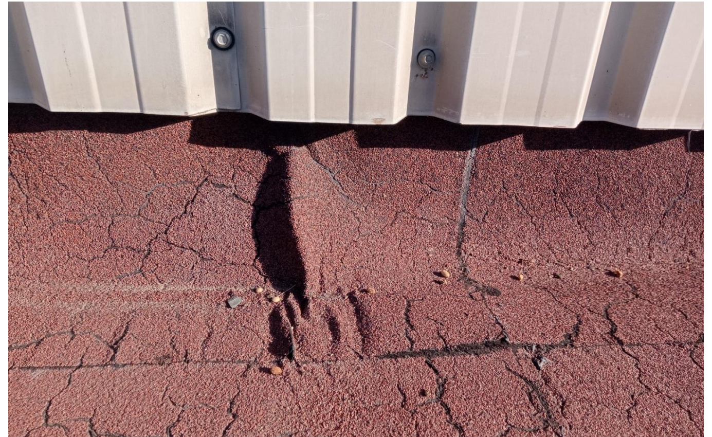
Escuarterament superficial de la làmina bituminosa superior
