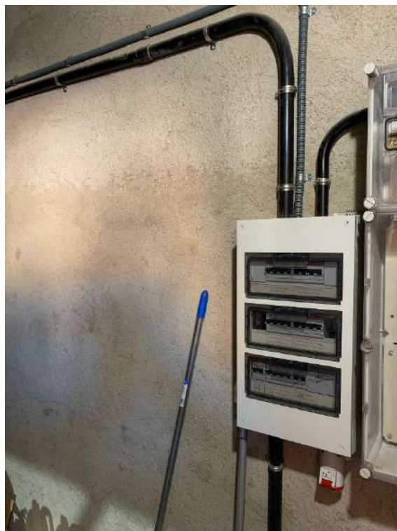
Il·lustració 3 Ubicació inversor fotovoltaic
