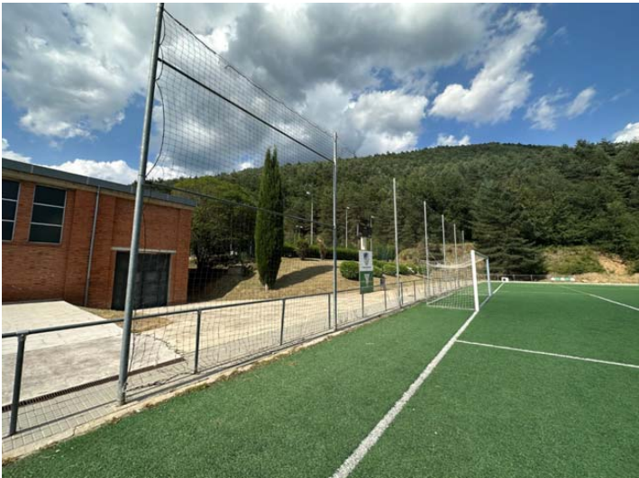
Imatge zona entre pavelló i pistes de tennis per abassegament de material
