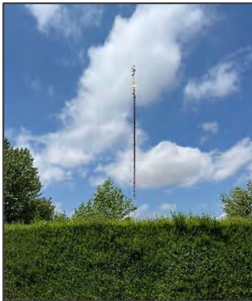
Antena EDAR existent
