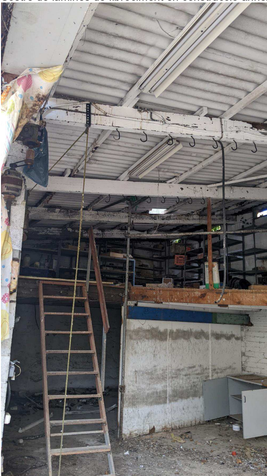
Sostre de làmines de fibrociment en construcció annexa a enderrocar
