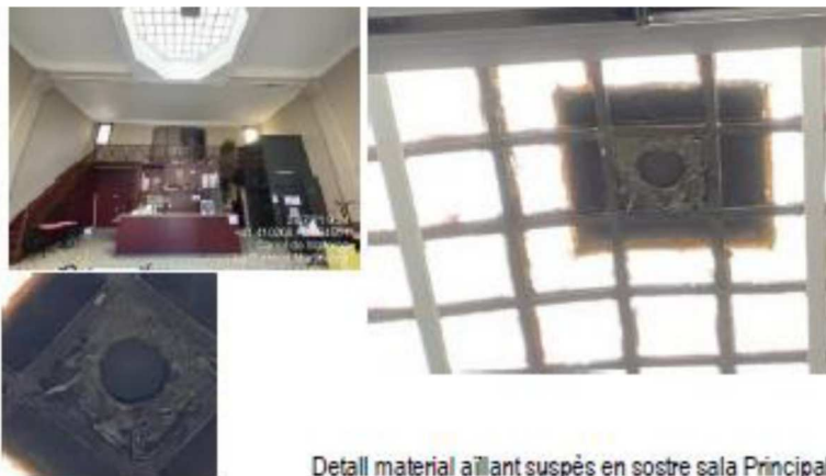
Detall material aïllant suspès en sostre sala Principal
