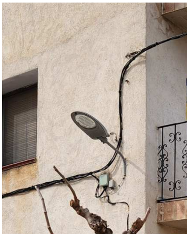
(Luminària a substituir)
