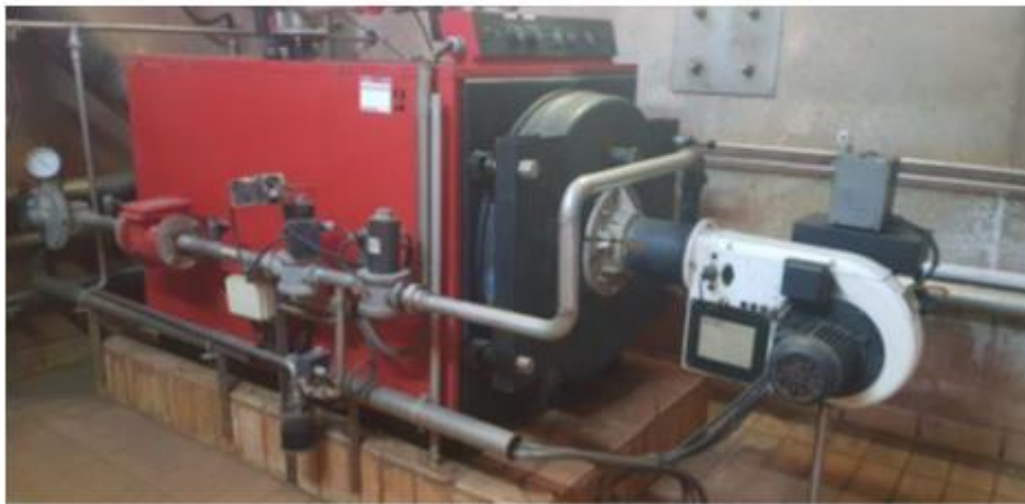
Figures 1, 2 i 3. Vista de la caldera i cremador existents.
