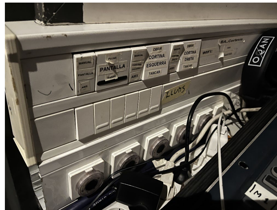
SALA TÈCNICA DE CONTROL
