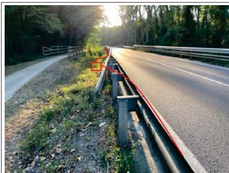
Pericó tipus A d'enllaç amb el tub metàl·lic, a terres (17020PE2430) a la sortida del pont sobre el Torrent d'en Ribera amb tipologia ST2a, a la carretera N-141e PK 105+405
