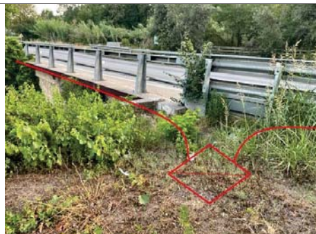
Pericó tipus A d'enllaç amb el tub metàl·lic, al voral (17020PE2416) a l'entrada del pont sobre la Sèquia de Bescanó, a la carretera N-141e PK 108+360
