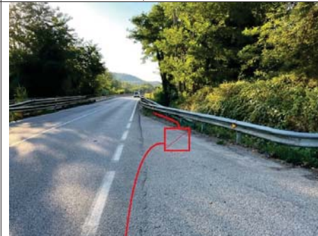
Pericó tipus B2 d'enllaç amb el tub metàl·lic, al voral (17020PE2419) a la sortida del pont sobre la Sèquia de Bescanó amb tipologia ST2a, a la carretera N-141e PK 106+705
