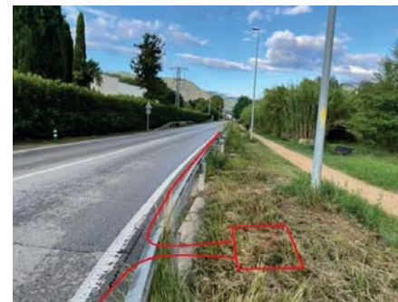
Micro-rasa tipologia ST-4, a la carretera N-141e PK 101+945, amb pericó tipus B2, al voral (17008PE2400)
