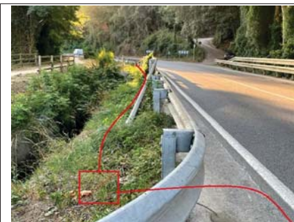
Pericó tipus A d'enllaç amb el tub metàl·lic, a terres (17020PE2432) a la sortida del pont sobre el Torrent de Ca l'Aulineta amb tipologia ST2a, a la carretera N-141e PK 104+980
