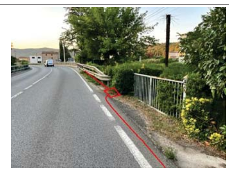
Pericó tipus A d'enllaç amb el tub metàl·lic, al voral (17020PE2417) a sortida del pont sobre la Sèquia de Bescanó amb tipologia ST-2a, a la carretera N-141e PK 108+380
