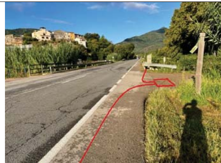
Micro-rasa tipologia ST-1, a l'entrada del pas del pont de la riera de St Amaç, amb pericó tipus B2, al voral (17008PE2402)
