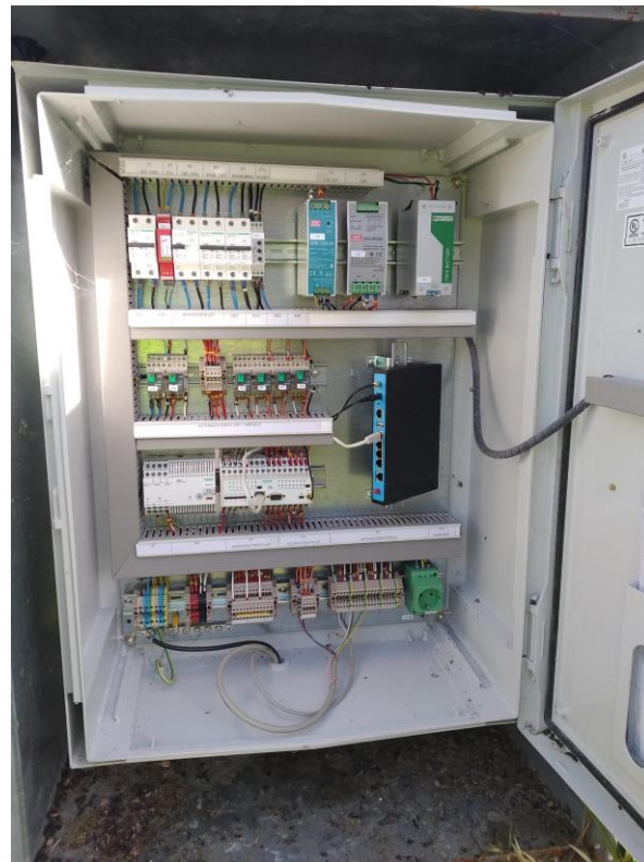
Figura 3. Quadre elèctric del pou Cabanau actual
