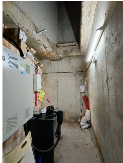
Imatge 8. Vista general de sala de màquines
