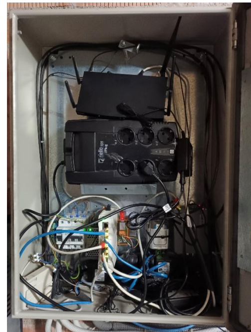
Imatge 10. Armari de telecomunicacions
