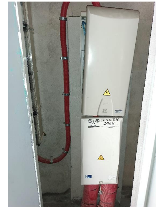
Imatge 16. Escomesa elèctrica
