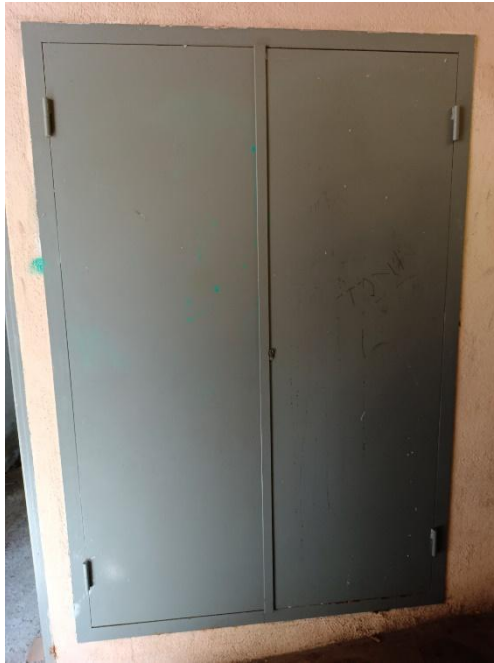
Imatge 15. Armari escomesa elèctrica
