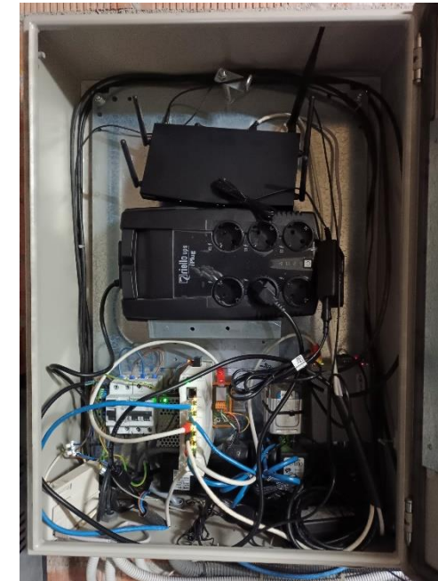
Imatge 10. Armari de telecomunicacions
