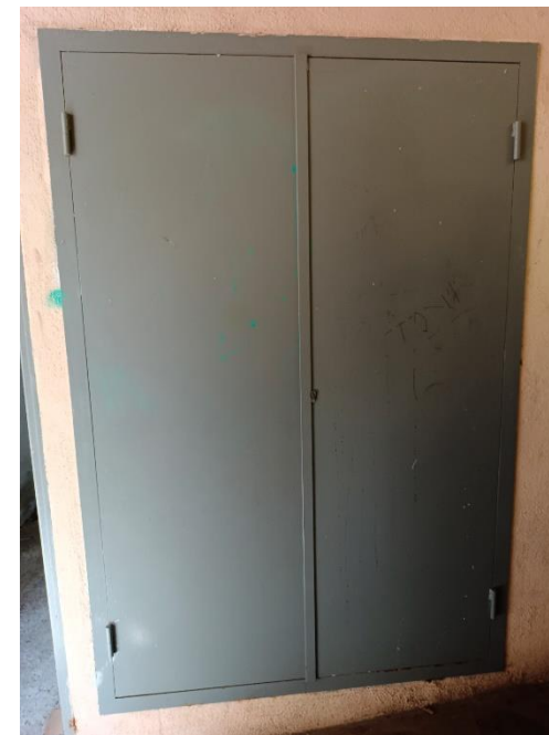
Imatge 15. Armari escomesa elèctrica
