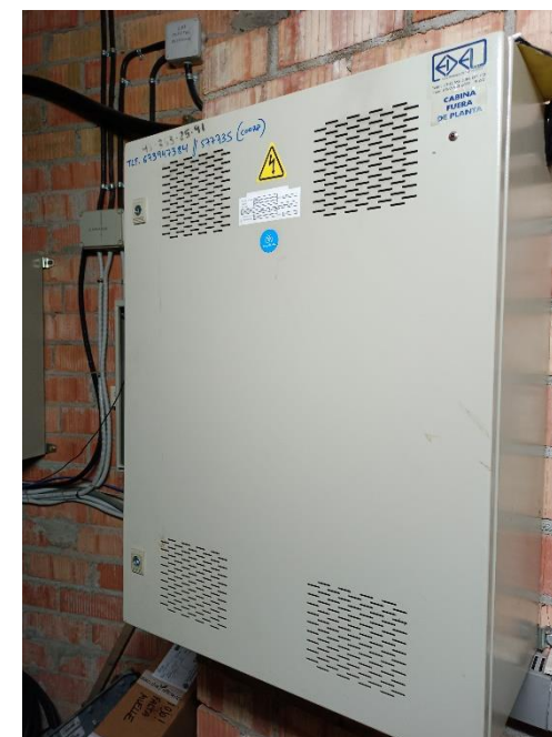
Imatge 9. Armari de maniobra existent
