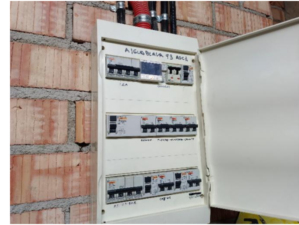
Imatge 11. Quadre elèctric existent
