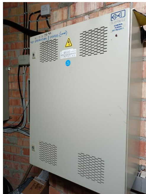
Imatge 9. Armari de maniobra existent
