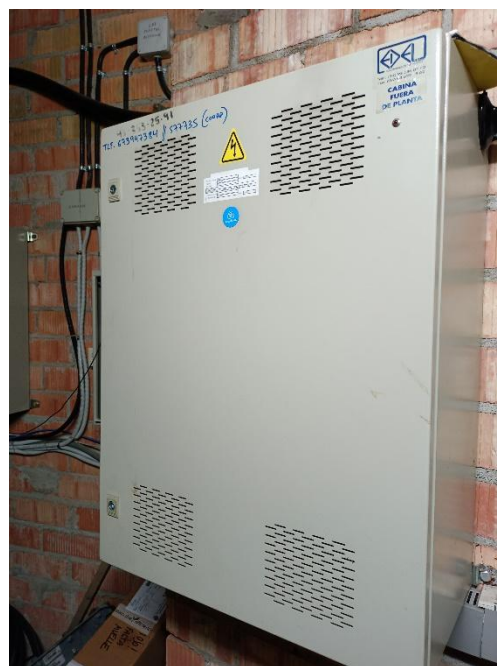
Imatge 9. Armari de maniobra existent
