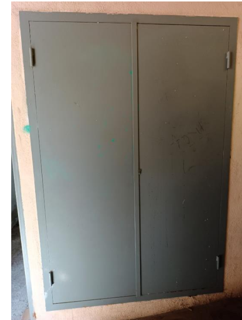
Imatge 14. Armari escomesa elèctrica
