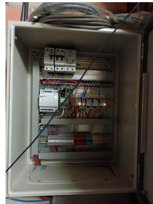
Imatge 13. Quadre elèctric existent
