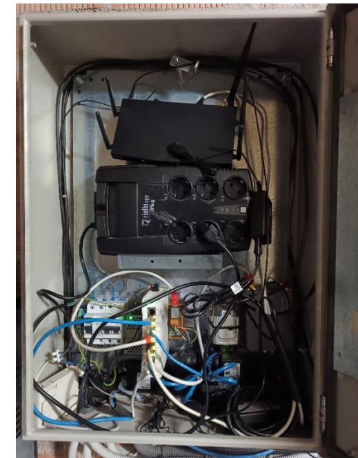
Imatge 10. Armari de telecomunicacions
