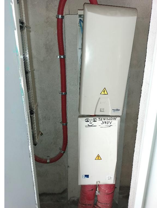
Imatge 16. Escomesa elèctrica
