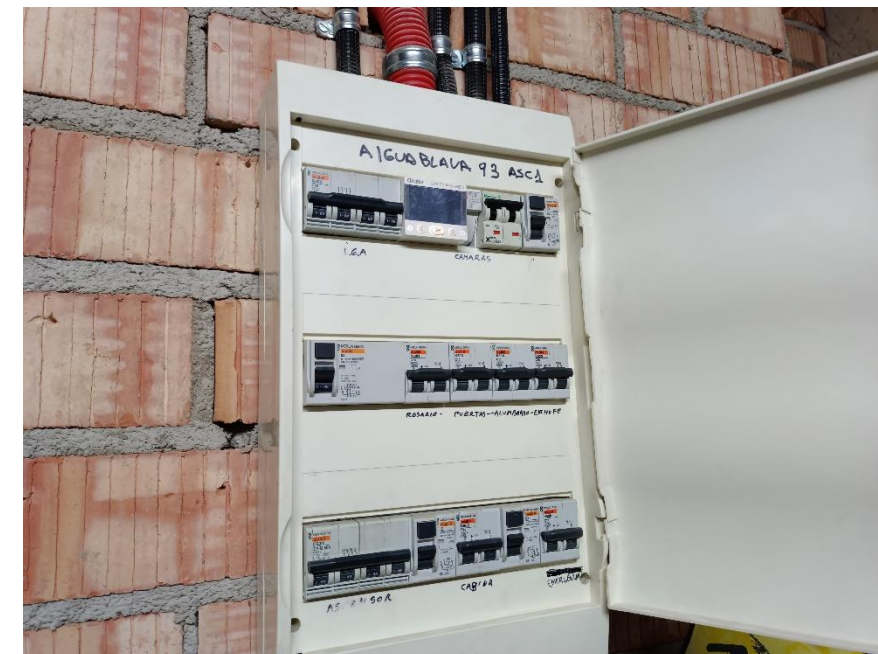
Imatge 11. Quadre elèctric existent
