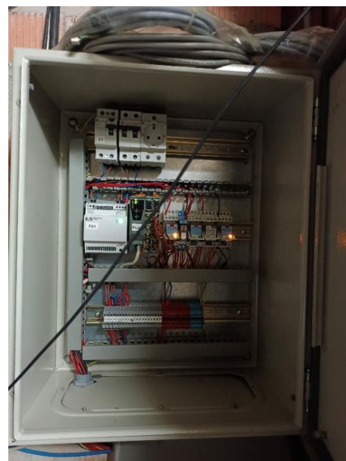
Imatge 13. Quadre elèctric existent
