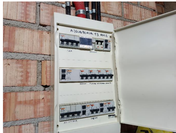
Imatge 11. Quadre elèctric existent
