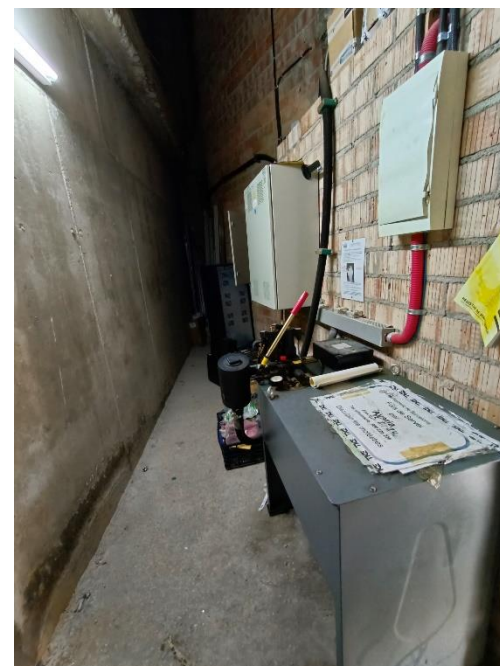
Imatge 14. Vista general sala de màquines
