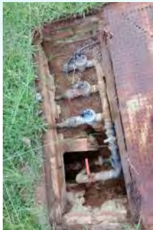
Piscina municipal. Arqueta de control de reg.
