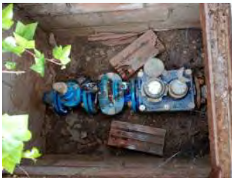
Piscina municipal. Arqueta d'escomesa.
