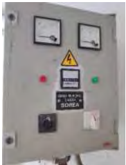
Armari de control del bombament 2
