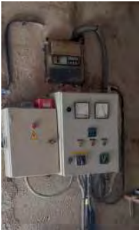
Armaris elèctrics interiors a desmuntat
