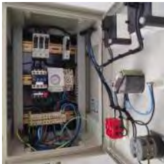
Armari de control del bombament 1
