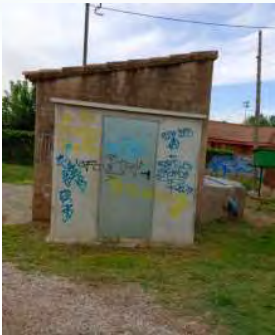
Pou Piscines, sala de cloració.
