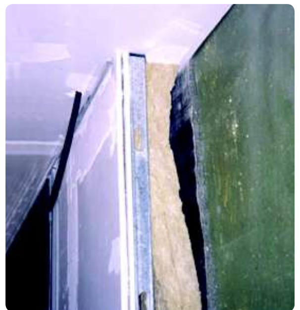
Trasdosado aislante con PKB-2.
