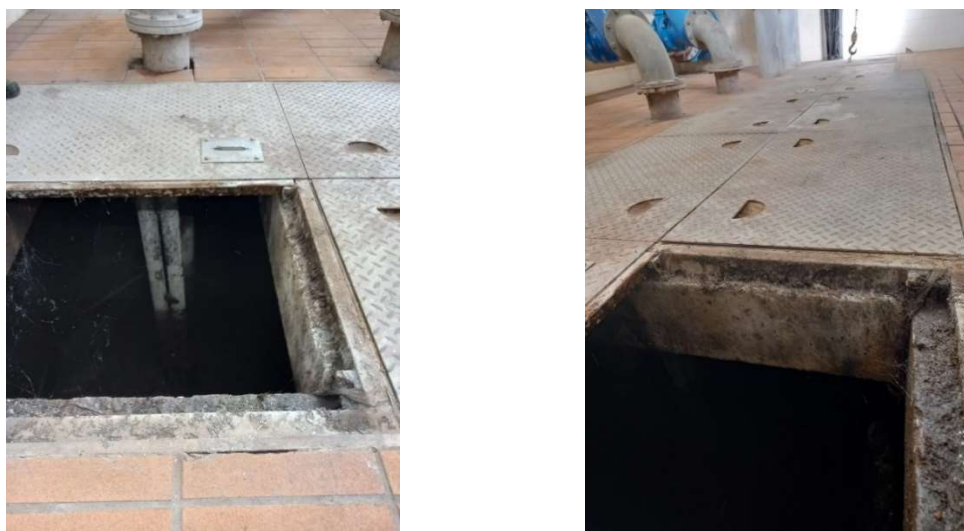
Figura 3. Vista de les tapes del bombeig a l'EDAR
