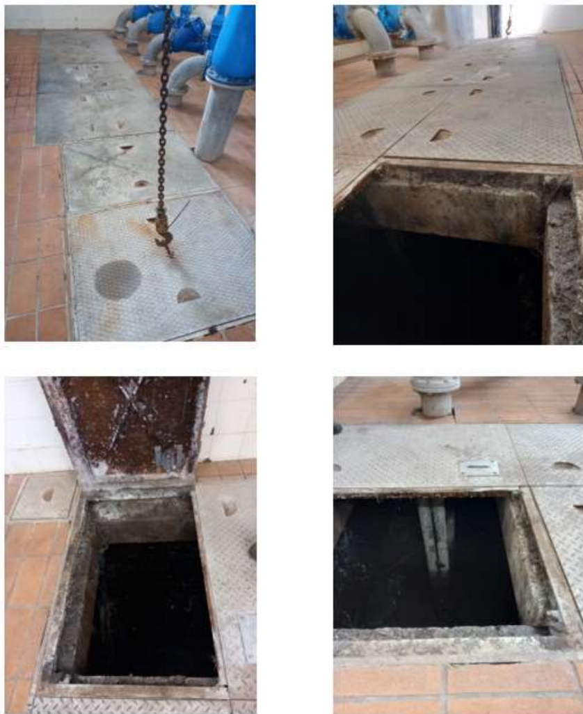
Figura 2. Vista de l'interior de l'EBAR Collet
