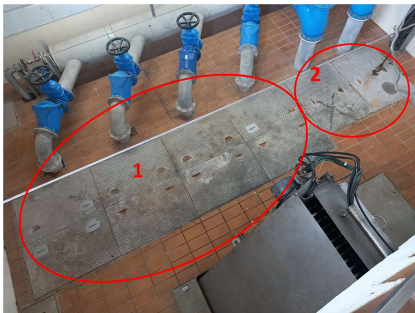
Figura 5. Vista de les tapes del bombeig a l'EDAR (assenyalades amb el núm. 1) i del bombeig al sanejament de Palamós (indicades amb el núm. 2)
