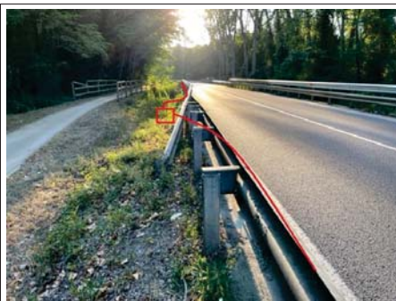
Pericó tipus A d'enllaç amb el tub metàl·lic, a terres (17020PE2430) a la sortida del pont sobre el Torrent d'en Ribera amb tipologia ST2a, a la carretera N-141e PK 105+405
