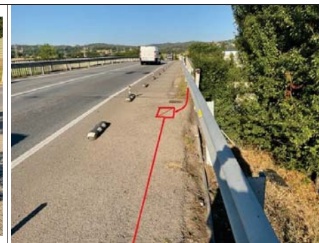
Pericó tipus A d'enllaç amb el tub metàl·lic, al voral (17155PE2410) a l'entrada del pont sobre l'autopista AP-7
