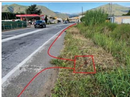
Micro-rasa tipologia ST-4, a la carretera N-141e PK 101+118, al creuament amb el C/ Triassa,, amb pericó tipus B2, al voral (17008PE2401)
