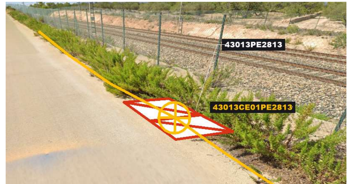
Fig 50: Ubicació caixa d'empalmament 43013CE01PE2813 en pericó 43013PE2813
