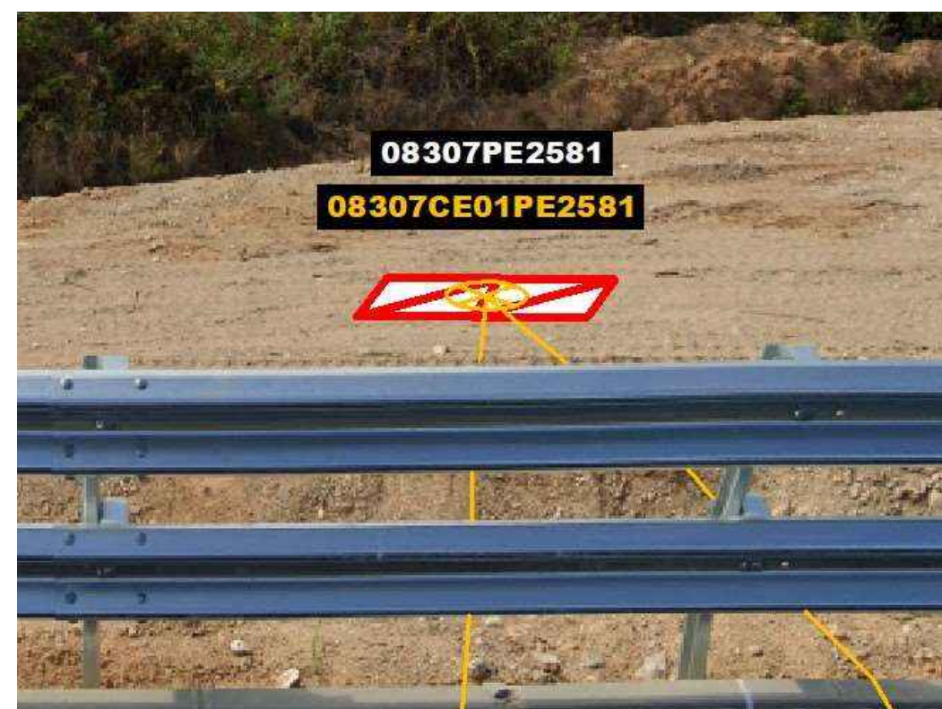
Fig.86: Ubicació caixa d'empalmament 08307CE01PE2581 en pericó 08307PE2581
