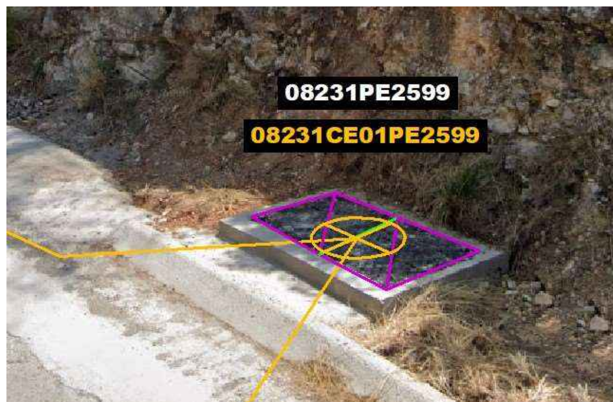
Fig.92: Ubicació caixa d'empalmament 08231CE01PE2599 en pericó existent no inventariada 08231PE2599
