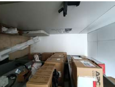
Figura 4 Espai per situar Inversor, quadres de proteccions i equip monitoratge
