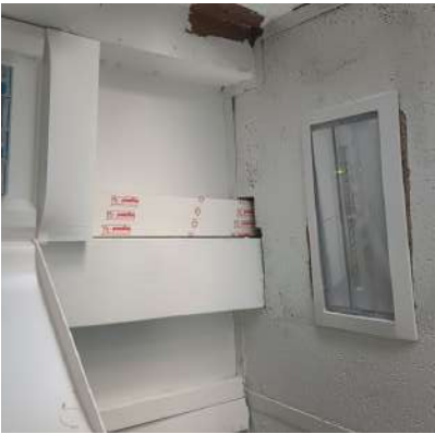
Pasos d'instal·lació existents per fals sostre
