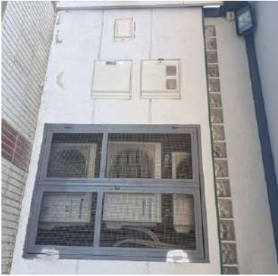
Nínxol existent amb escamesa elèctrica, d'aigua i equips clima
