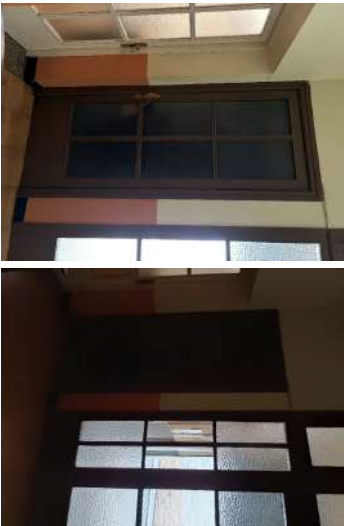
Figura 4 Porta per accedere a la saleta on s'instal·larà l'inversor
