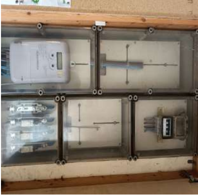
Escomesa elèctrica (TMF-1)
