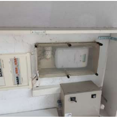
Escomesa elèctrica (CPM-MF4)
