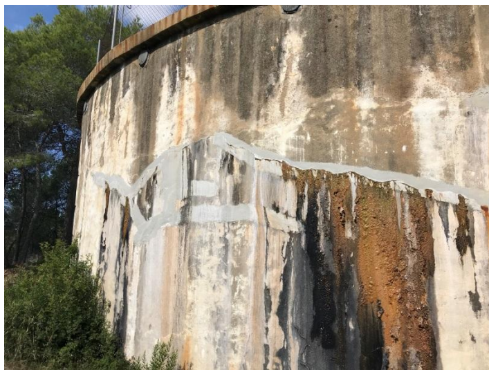
Foto 2: Estat deficient de la paret del dipòsit
