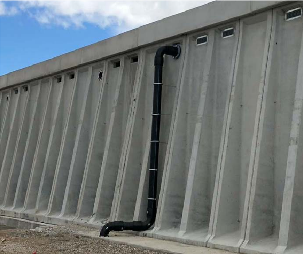
IMATGE DEL DETALL D'ENTRADA D'AIGUA AL NOU DIPÒSIT
