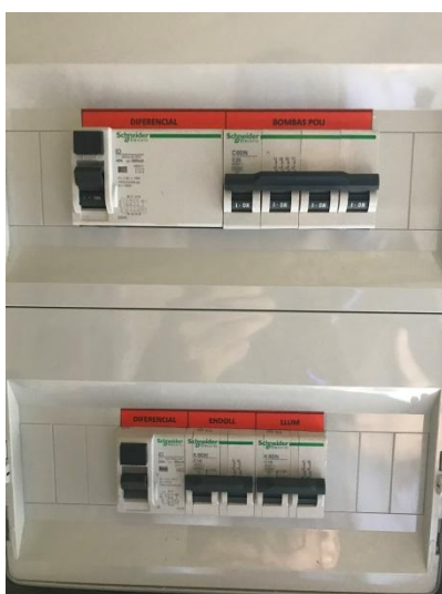
Fotos 11 i 12: Interior caseta de control
