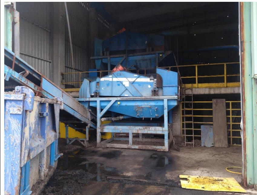
22.- Sortida transportador digest (transportador TB)
