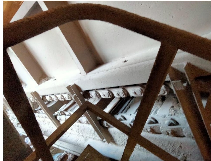
19.-Alimentador principal de plaques línia 2.
