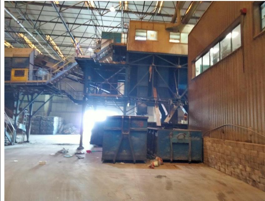
14.- Cabina triatge línia 1
