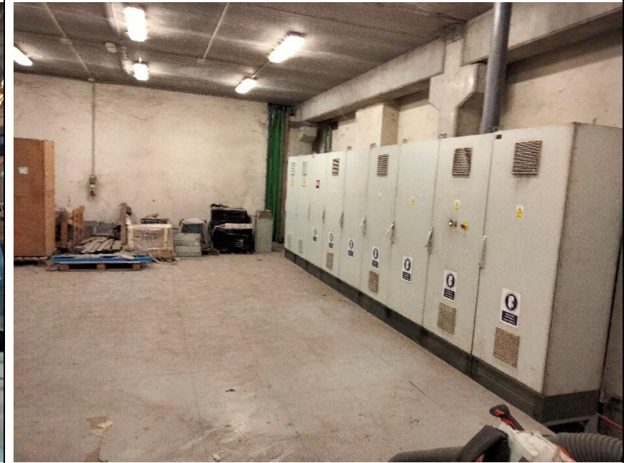
9.- Sala Elèctrica pretractament.
