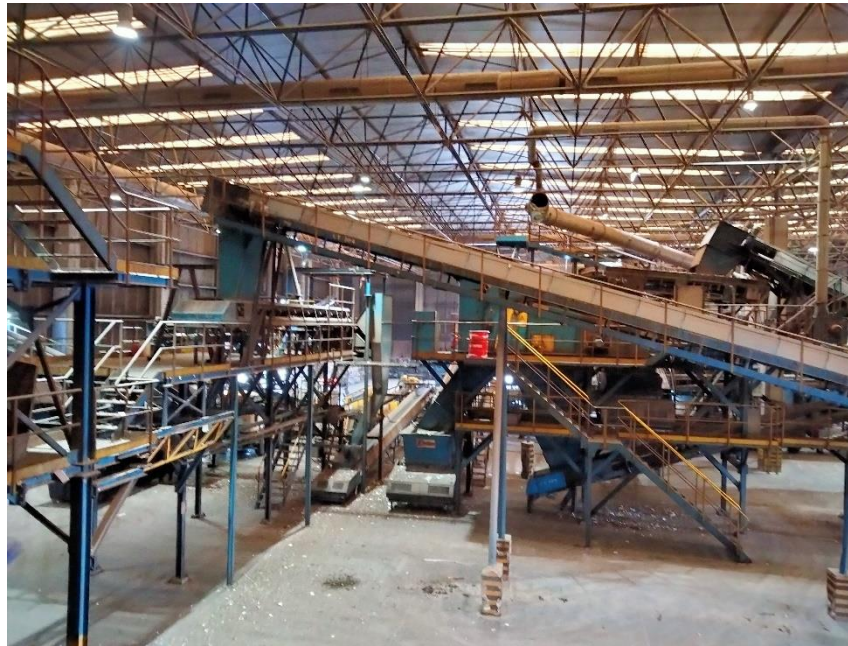
13.- Cinta de MOR des de línia 1
