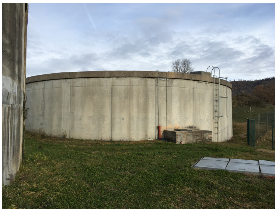
Dipòsit Nou de les Bassetes
