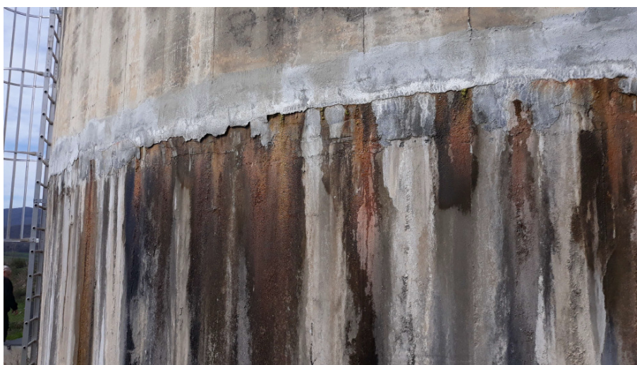
Estat actual de la junta horitzontal
