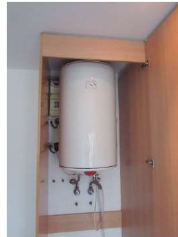
Acumuladors elèctrics habitatges.
