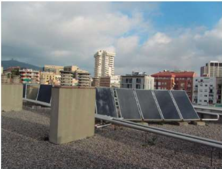
Plaques solars a coberta.
