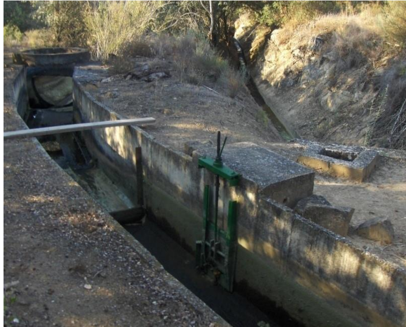
Punt de captació de l'aigua de la sèquia del Canal d'Urgell
