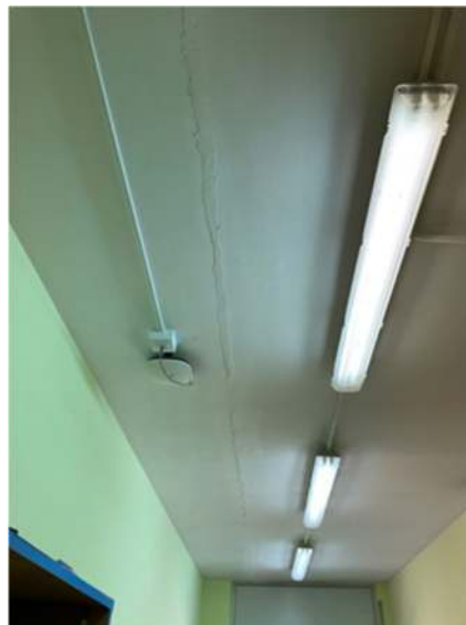
Fissures sostre planta pis
