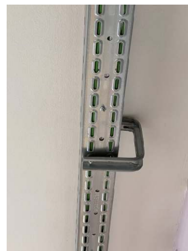
Safata existent pas d'instal·lacions
