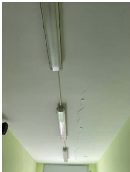
Fissures sostre planta baixa
