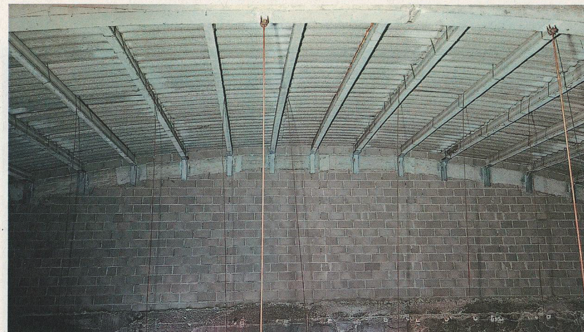
Imatge 3 Part superior de la façana Sud reconstruïda, traves superior en arc de formigó armat, i mènsules metàl·liques de recolzament de corretges degut al seu desplaçament
