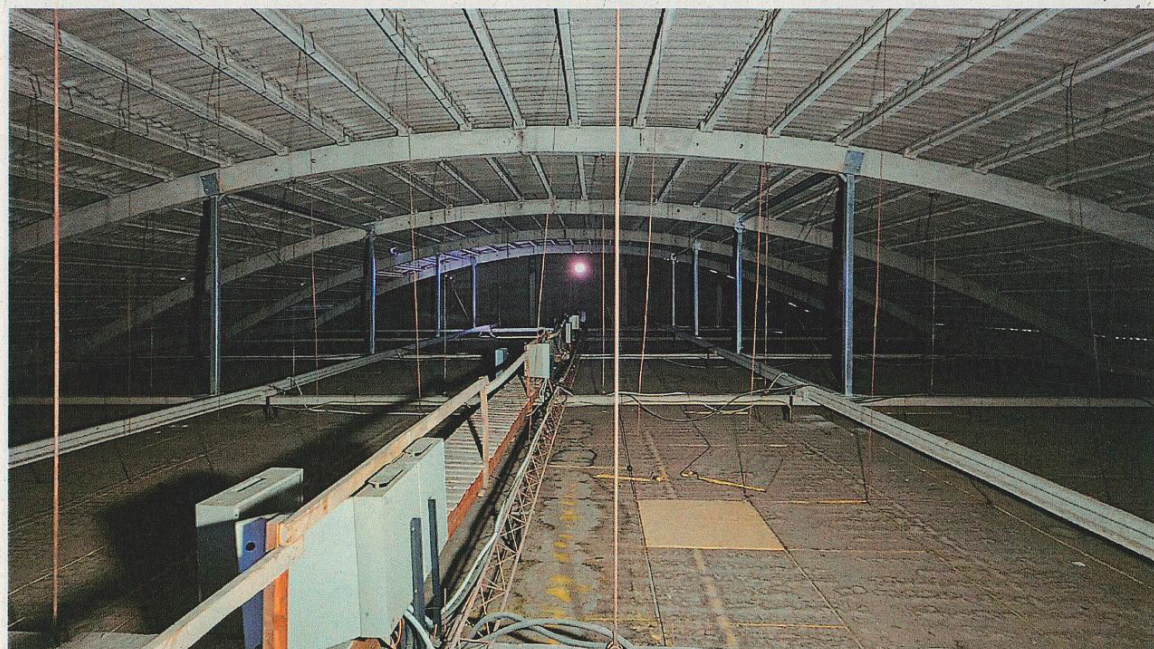
Imatge 2 Encavallades no triangulades en el seu mateix pla. Passera d'accés sota coberta en males condicions
