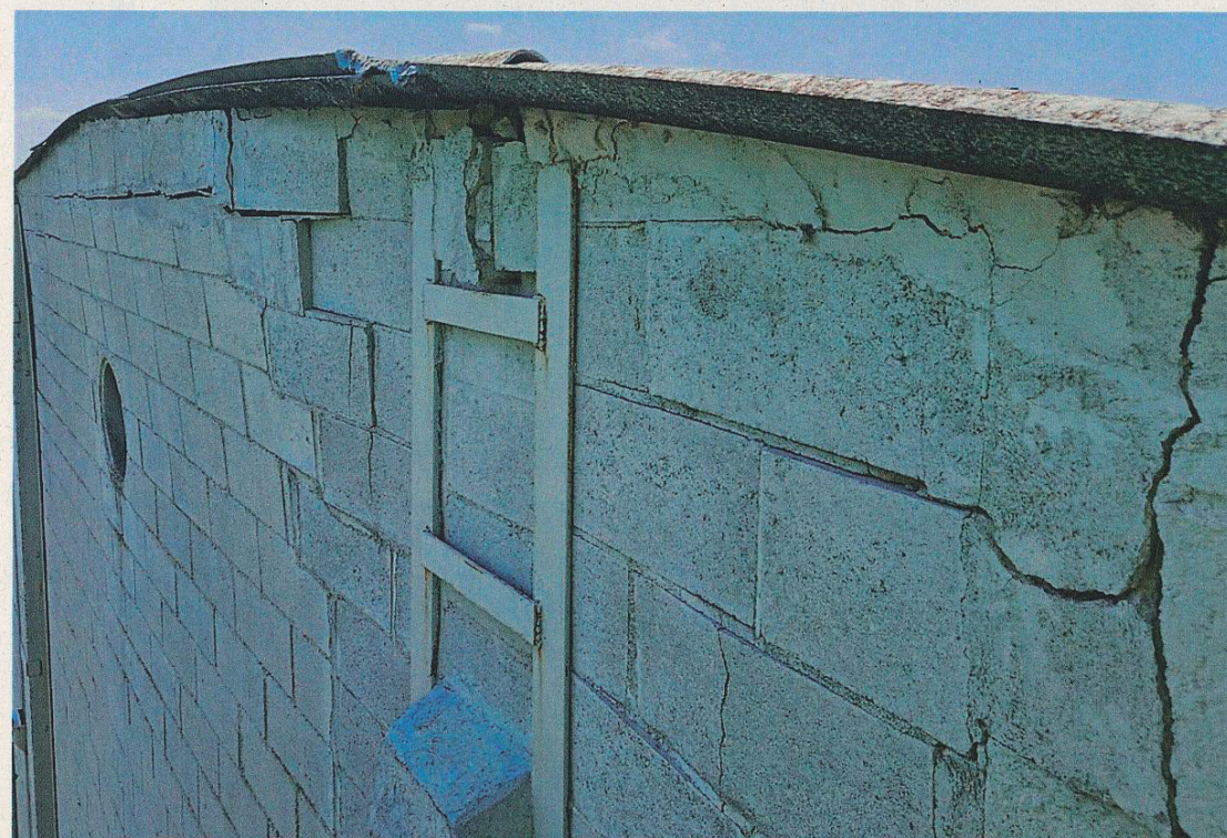
Imatges 7, 8 i 9 Esquerdas i peces desplaçades al coronament de la façana Nord, posteriors a la seva reparació
