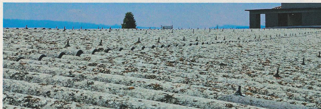
Imatge 10 Coberta de fibrociment clarament degradada
