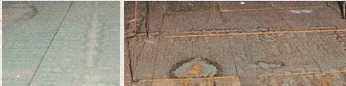
Imatges 14 i15 Plaques del fals sostre deteriorades per filtracions d'aigua de la coberta
