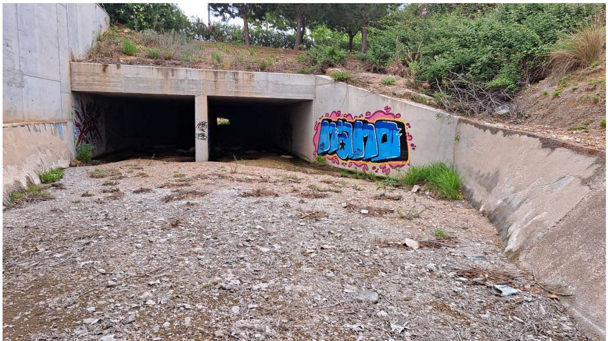
ACUMULACIÓ DE SEDIMENT PROVOCADA PER EL CANVI DE SECCIÓ.
