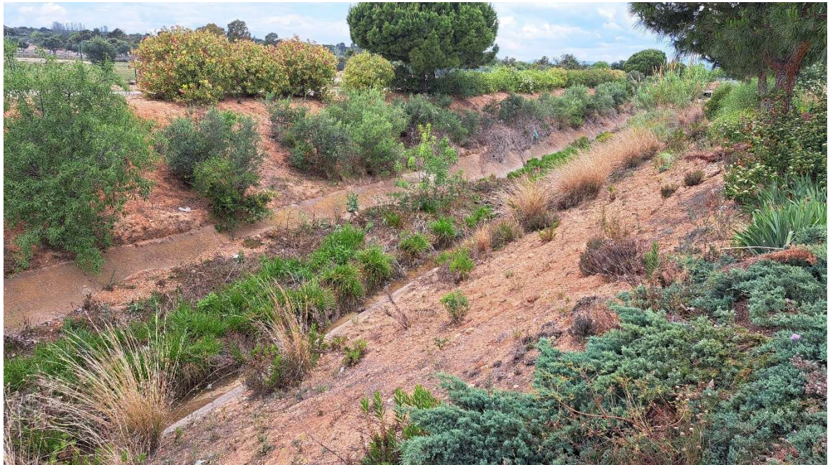
ACUMULACIÓ DE FINS, ÀRIDS I VEGETACIÓ A LA BASE DEL CANAL, REDUINT LA SECCIÓ ÚTIL DE CAPACITAT DE DESGUÀS.
