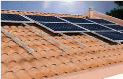
Estructura especial en cubierta coplanar
