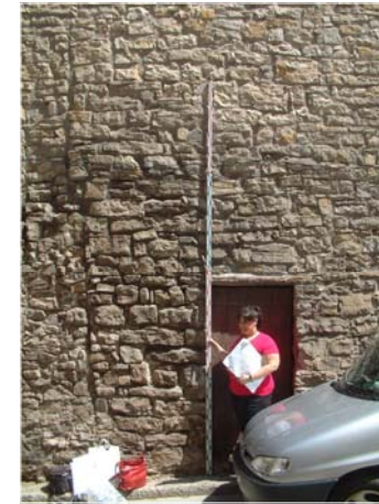
④ Fissura vertical estructural Sanejament de la pedra sorrenca i i rejuntat de les fissures i la pedra. Col·locació de tirants metàl·lics per consolidació estructural
