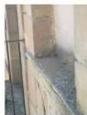
④ Humitats Substitució parcial per encaix de nova pedra
