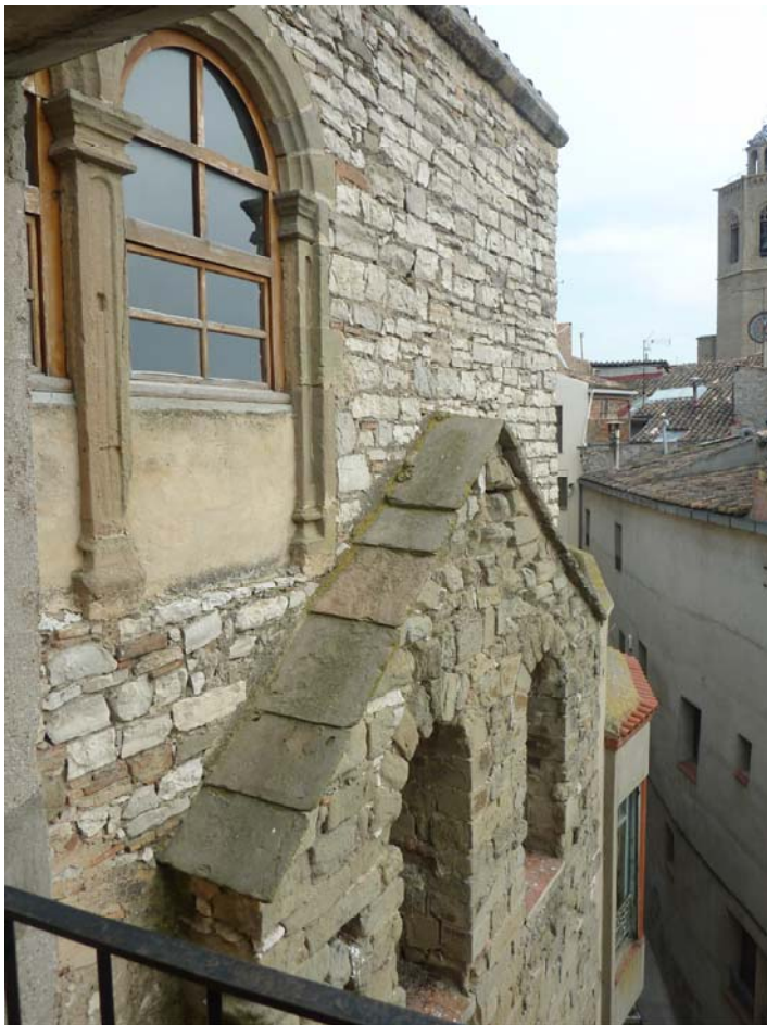
MANCA IMPERMEABILITZACIÓ, ESCOPIDOR I REMATS EN CORONAMENTS. DESGAST I FILTRACIONS EN FAÇANA ESPADANYA ESSLÉSIA ROMÀNICA DE SANT JOAN PER REJUNTAR SELECTIVAMENT.
