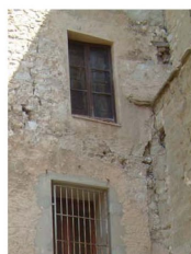
⑥ Fissura vertical estructural i descrostant parcial de l'arrebossat estucat de morter de calç deixant la pedra a la vista Consolidació per injecció de morter de calç i claus de lligat d'acer inoxidable
