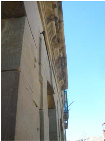
⑧ Desgast i descrostament cornissa Restitució concavitats amb morter de calç i sorra de pedra sorrenca triturada
