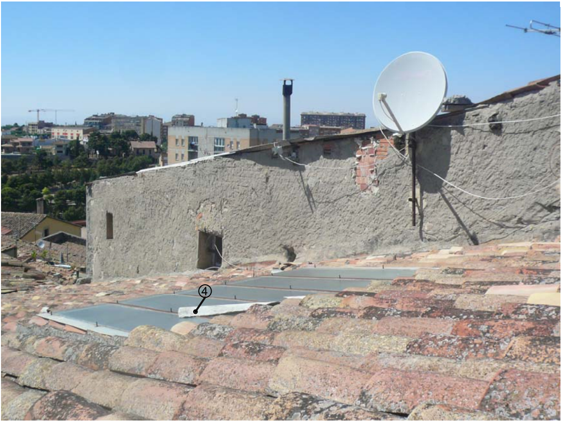
COBERTA SENSE REMATS I AMB FILTRACIONS. SENSE PASSERES DE MANTENIMENT.
