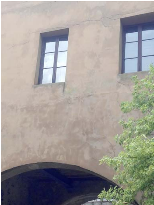
MANCA DE PROTECCIÓ DEL REVESTIMENT EXTERIOR. ARREBOSSAT DE MORTER DE PÒRTLAND ESCROSTONAT.
