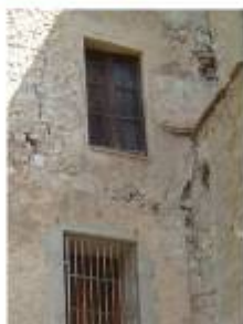
⑥ Fisura vertical estructural i descrostament parcial de l'arrebossat estucat de morter de calç deixant la pedra a la vista Consolidació per injecció de morter de calç i claus de lligat d'acer inoxidable
