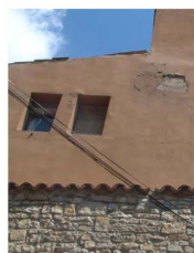
① Humitats i descrostant parcial de l'arrebossat estucat de morter de calç Sanejament de l'arrebossat i les humitats i tornar a realitzar l'estucat a la calç
