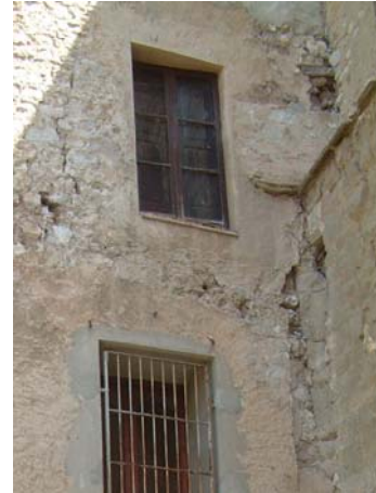
⑥ Fissura vertical estructural i descrostament parcial de l'arrebossat estucat de morter de calç deixant la pedra a la vista Consolidació per injecció de morter de calç i claus de lligat d'acer inoxidable
