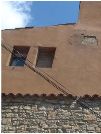
① Humitats i descrostament parcial de l'arrebossat estucat de morter de calç Sanejament de l'arrebossat i les humitats i tornar a realitzar l'estucat a la calç
