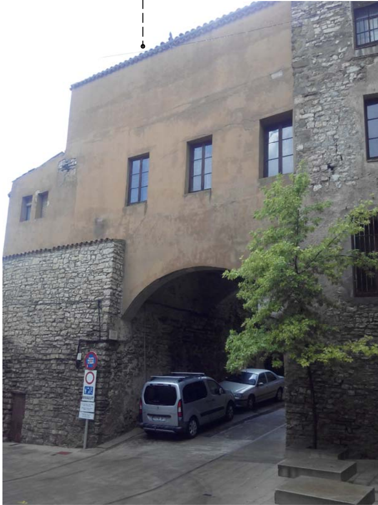
FAÇANA SUD (Fotos any 2018) AMB PROBLEMES DE FILTRACIONS EN DESCROSTAMENTS I MOVIMENTS. ENTRE MURS DE DISTINTA NATURALES CONSTRUCTIVA. S'APRECIA EL DETERIORAMENT PROGRESSIU VERS LES VISTES DE 2011.
