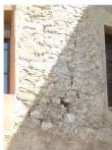
⑦ Fisura vertical estructural i descrostament parcial de l'arrebossat estucat de morter de calç deixant la pedra a la vista Sanejament de l'arrebossat i tornar a realitzar l'estucat a la calç i consolidació per injecció de morter de calç i claus de lligat d'acer inoxidable
