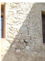
⑦ Fissura vertical estructural i descrostant parcial de l'arrebossat estucat de morter de calç deixant la pedra a la vista Sanejament de l'arrebossat i tornar a realitzar l'estucat a la calç i consolidació per injecció de morter de calç i claus de lligat d'acer inoxidable
