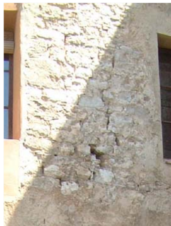
⑦ Fissura vertical estructural i descrostament parcial de l'arrebossat estucat de morter de calç deixant la pedra a la vista Sanejament de l'arrebossat i tornar a realitzar l'estucat a la calç i consolidació per injecció de morter de calç i claus de lligat d'acer inoxidable
