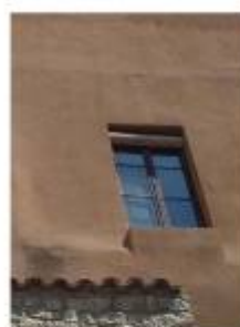
③ Descrostament i fisures horitzontals estructurals en forjats existents Rejuntat de fisura i sanejament de l'arrebossat i tornar a realitzar l'estucat a la calç
