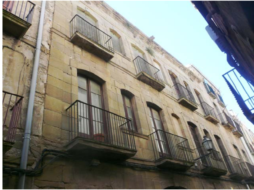
LLOSES DE BALCÓ ORIGINALS EN DESCOMPOSICIÓ QUE CAL ATURAR I REPARAR.
