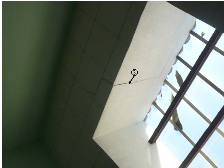
LLUERNARI GALERIA ESCALES INTERIORS. PRESENTA INESTABILITAT ESTRUCTURAL.
