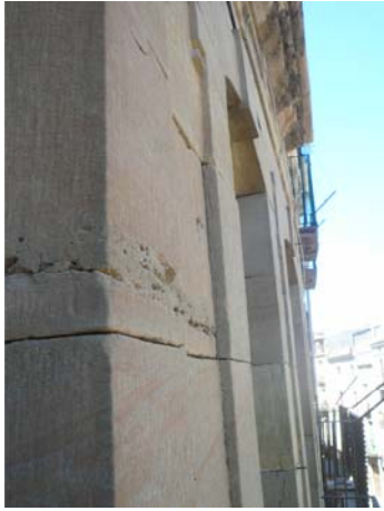
② Fissures horitzontals a la pedra Consolidació per injecció de morter de calç i claus de lligat d'acer inox
