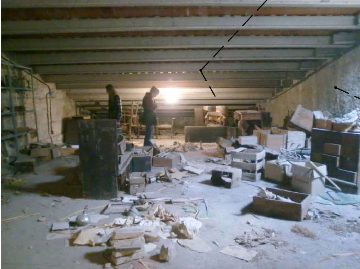
Plana sota coberta orientació nord-oest edifici Antiga Biblioteca - Filtracions laterals
