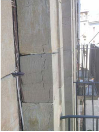
③ Fissures verticals a la pedra Consolidació per injecció de morter de calç i claus de lligat d'acer inox
