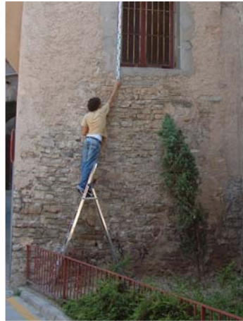
⑤ Descrostament parcial de l'arrebossat estucat de morter de calç deixant la pedra a la vista Sanejament de l'arrebossat i tornar a realitzar l'estucat a la calç
