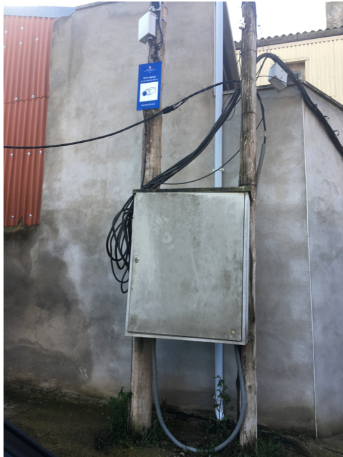
Quadre nº1: quadre general de l'enllumenat públic a reformar
