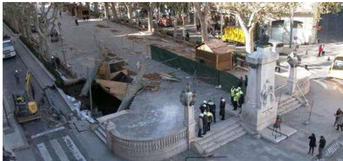
Figura 3. Vista general de l'esvoranc (Font: Obres d'emergència per la reparació de la canalització de la riera Galligants a la Rambla de Figueres)
