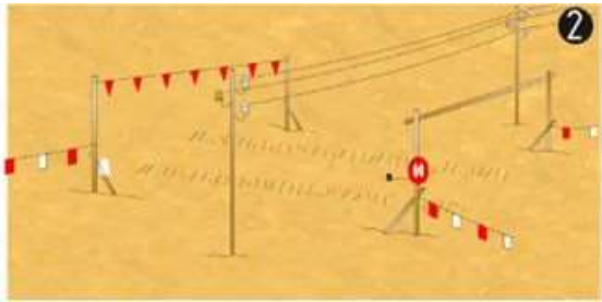
Pòrtic de balisament, protecció de línies elèctriques
