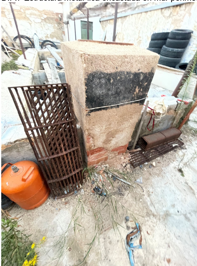
D.F.8 Caixa amb clau de pas de la bassa.
