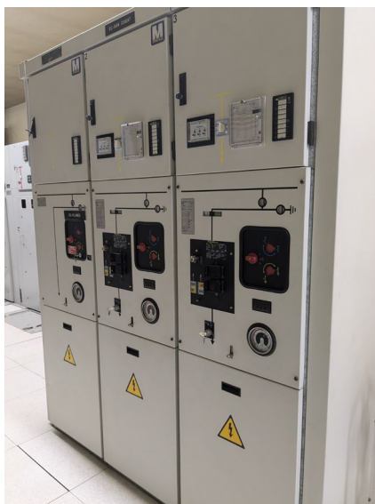
Fig 2. Actuals cabines 25kV CBGS-0 a substituir
