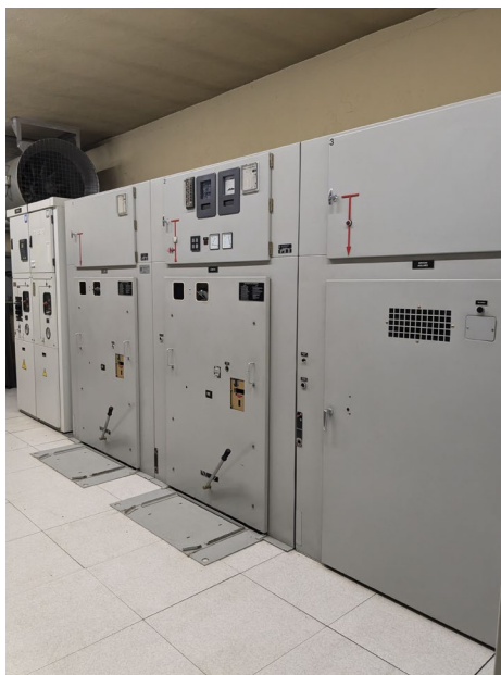
Fig 1. Actuals cabines 25kV CRC-36 a substituir
