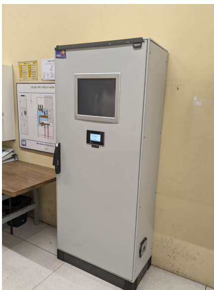
Fig 4. Actual panell de control centralitzat a substituir
