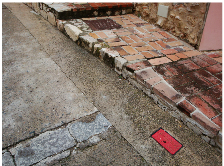
Fotografia 06: carrer Barranc d'en Pol cruïlla carrer de les Flors, detall arqueta i vorera dreta segons pujada
