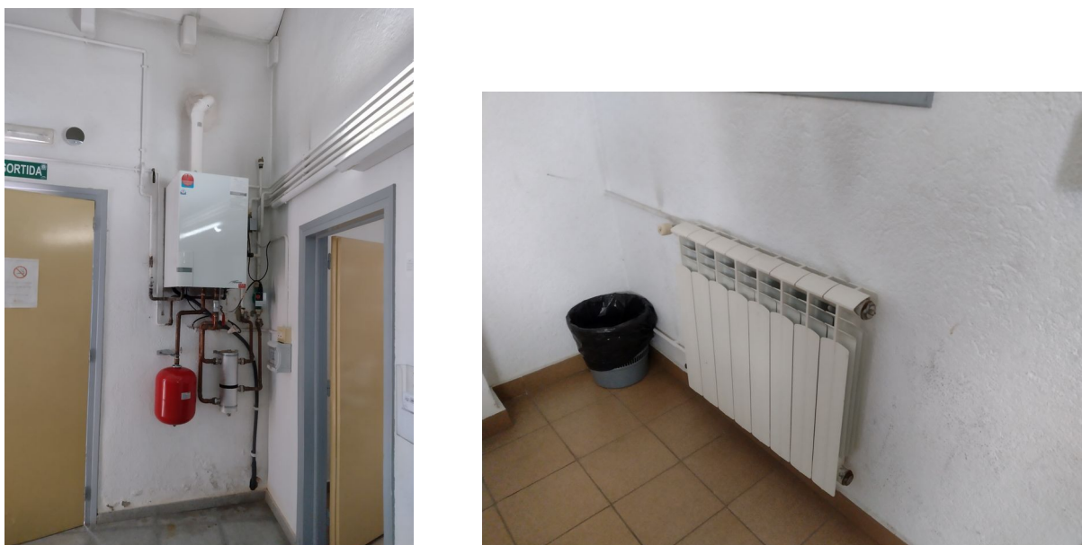
Figura 6: Situació caldera i radiadors club d'escacs.
