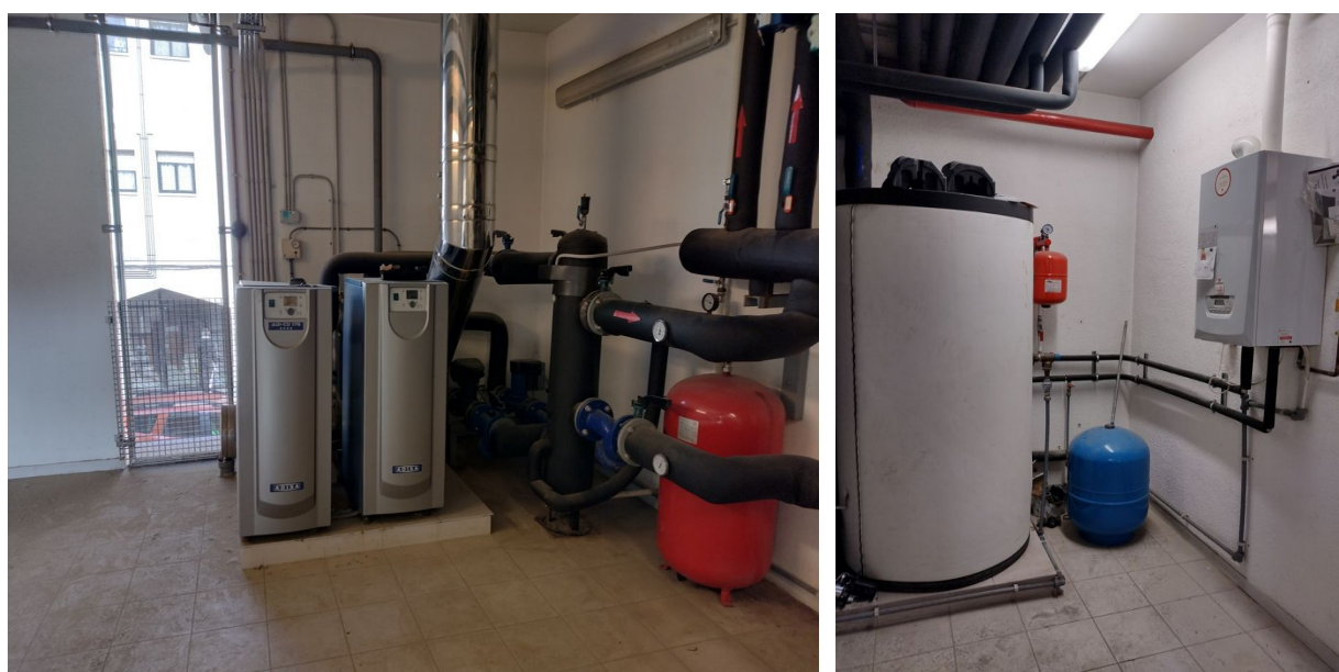
Figures 4 i 5: Calderes i acumulador de sala tècnica de la escola.
