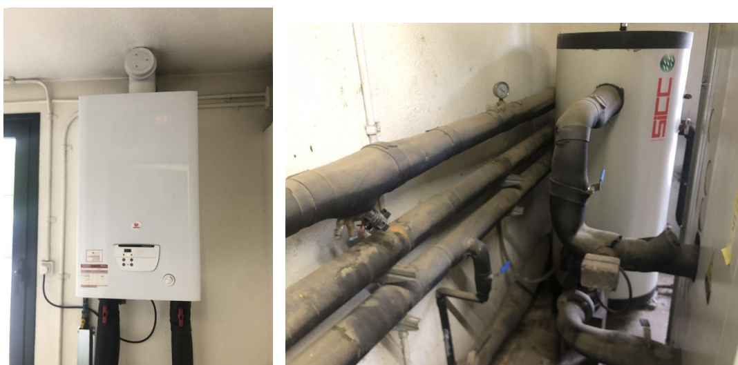
Figures 2 i 3: Caldera i acumulador de sala tècnica de Can Lletres.
