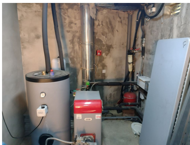
Figura 7: Caldera i acumulador de sala tècnica de la escola bressol
