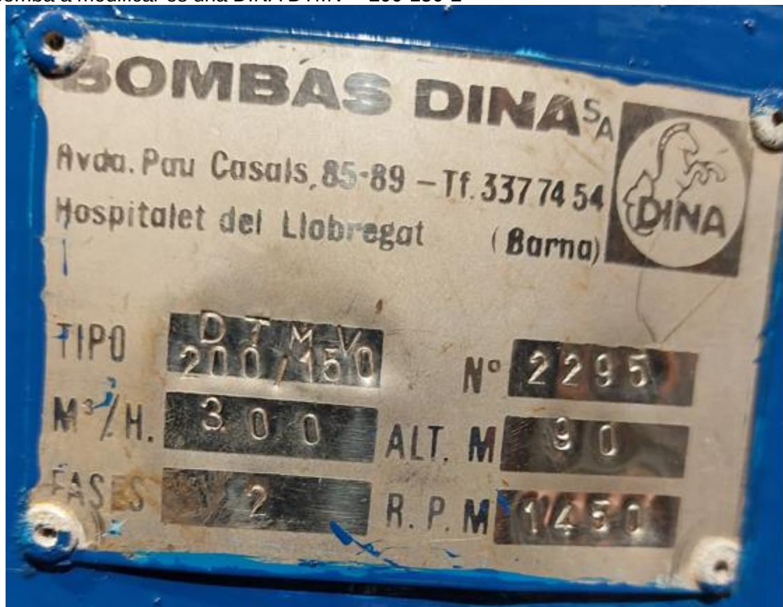
Imatge 1. Placa de la bomba
