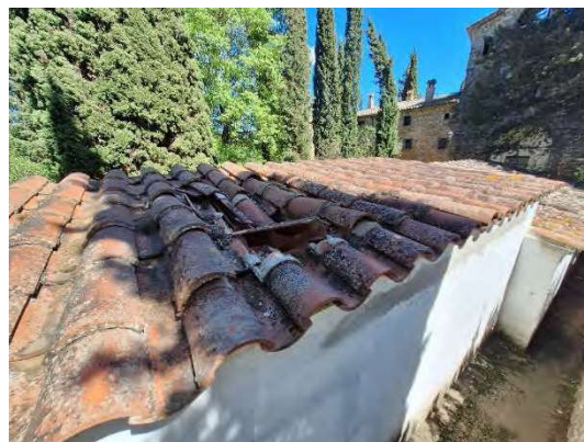
Esfondrament puntual coberta
