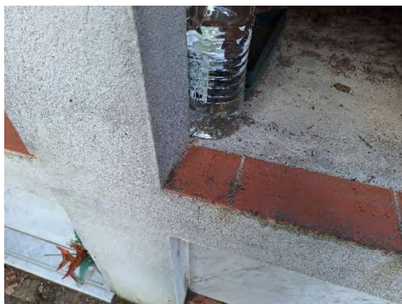
Detall del trencament del dintell entre nínxols
