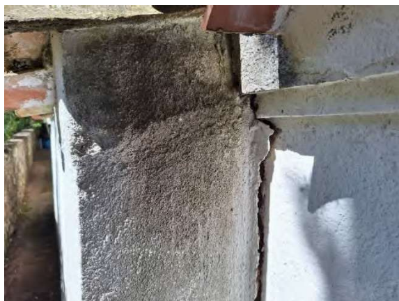
Façana posterior esquerda vertical com a resultat d'una junta constructiva
