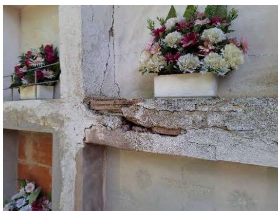
Degradació dels llindes i ampits de les obertures.
