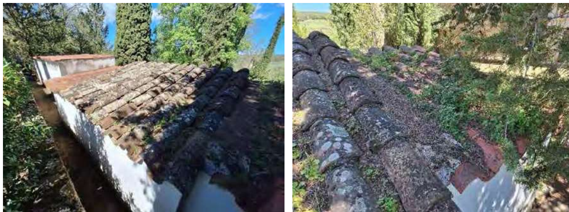
Vista de les cobertes més afectades per l'acumulació de restes vegetals i plantes.
