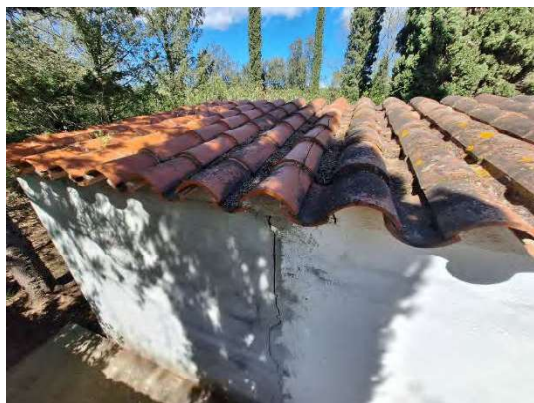
Assentament amb trencament de la coberta
