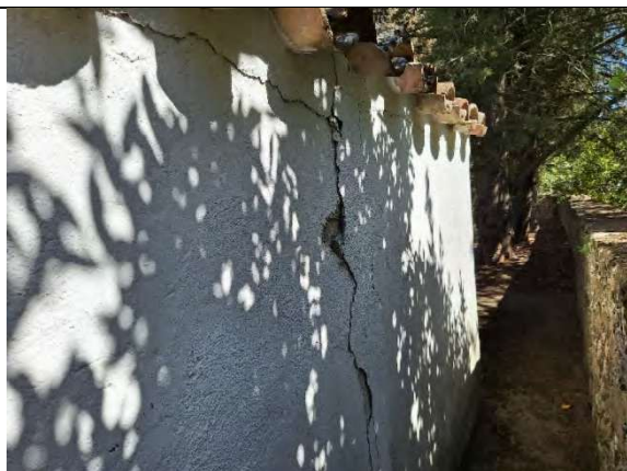
Vista façana posterior, amb esquerda vertical com a resultat d'una junta constructiva
