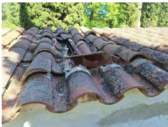
Vista de la coberta esfondrada
