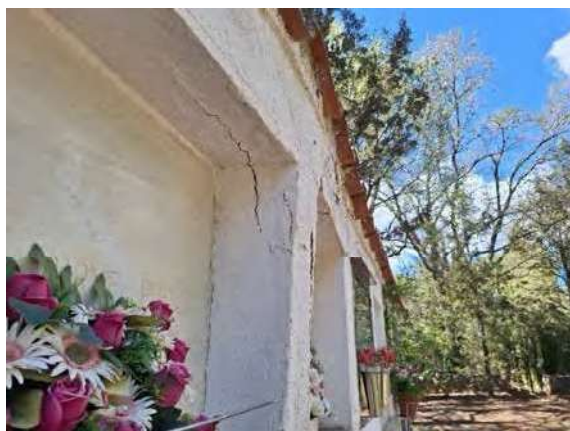
Vista del nínxol n. 11 amb esquerdes i indiquen empenes
