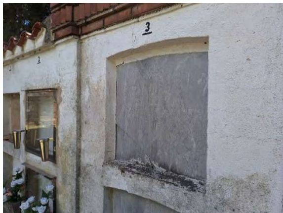
Esquerda vertical, amb trencament de les llindes i fins i tot de la làpida.
