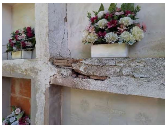
Degradació dels elements de façana
