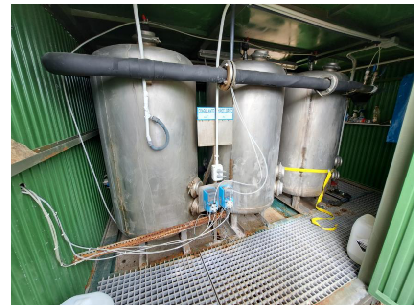
Figura 6: E.T.A.P. Subirà 1. Filtració
