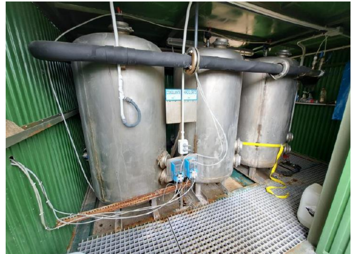
Figura 5. E.T.A.P. Subirà 1. Filtració
