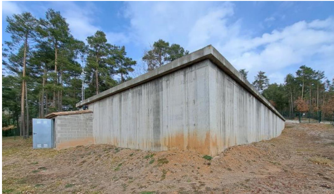
Figura 3. Dipòsit de Subirà 1 gran (aigua crua)
