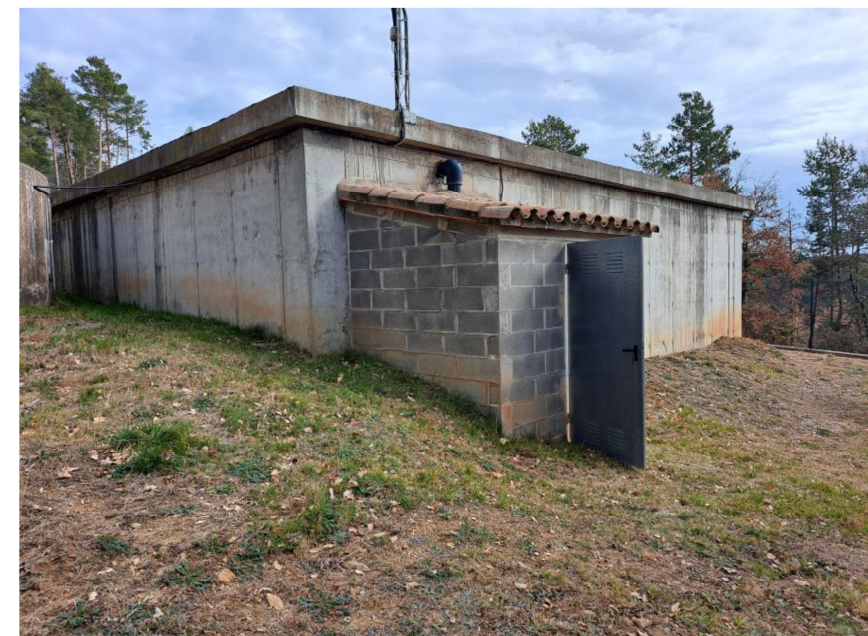
Figura 7: Caseta de cloració
