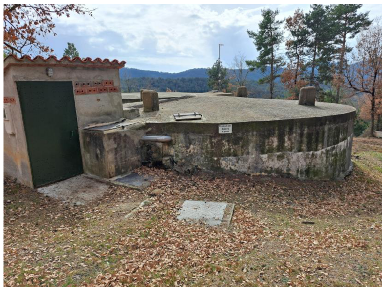
Figura 5: Dipòsit de Subirà 1 petit (aigua tractada)
